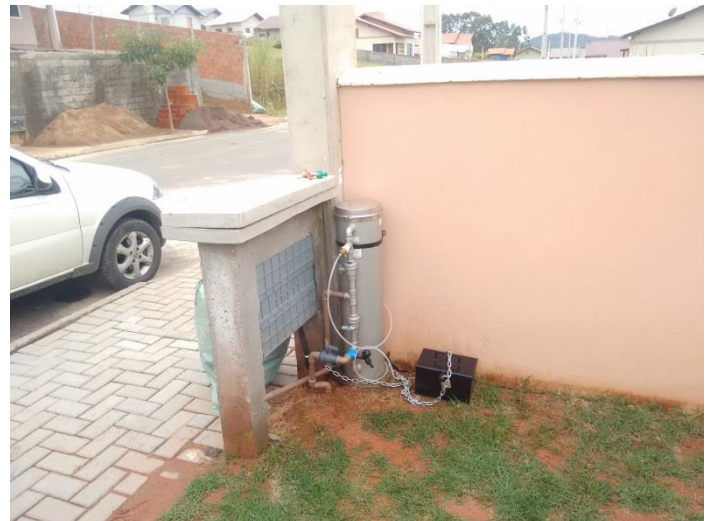
Figura 2 – Local de instalação do datalogger de pressão
