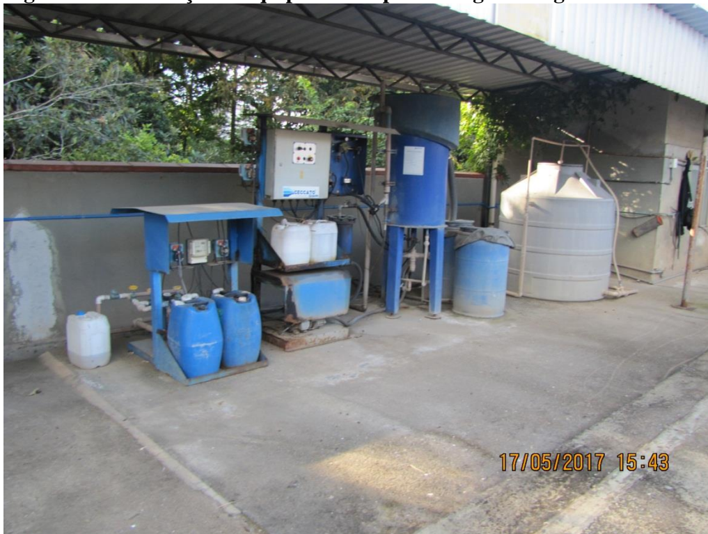
Figura 10 – Instalações e equipamentos para lavagem integral dos veículos.
