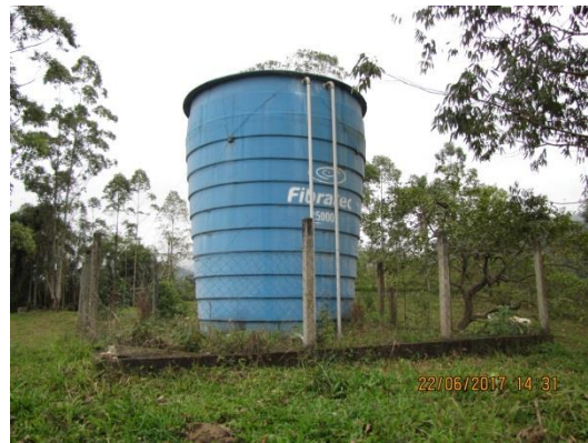
Figura 4: Reservatório de distribuição de água do Bairro Beira-Rio.
