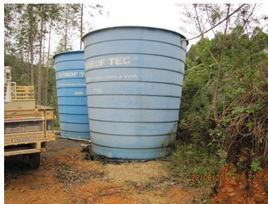
Figura 14: Vista em perfil dos reservatórios de distribuição de água.
