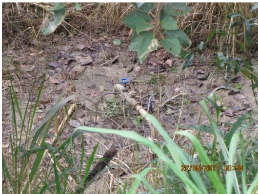
Figura 9: Poço de captação de água bruta do Bairro Águas Negras. Fonte: AGIR (2017).
