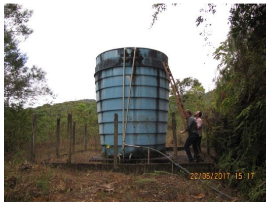
Figura 6: Reservatório de distribuição de água do Bairro Lajeado.
