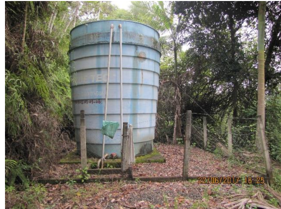
Figura 8: Reservatório de distribuição de água do Bairro Pedras Grandes.
