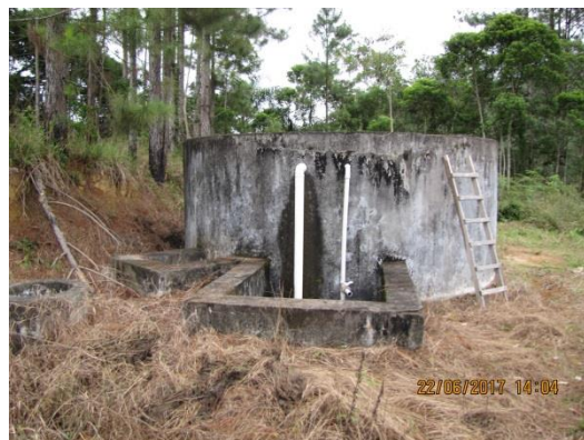
Figura 2: Reservatório de distribuição de água do Ribeirão do Ouro.
