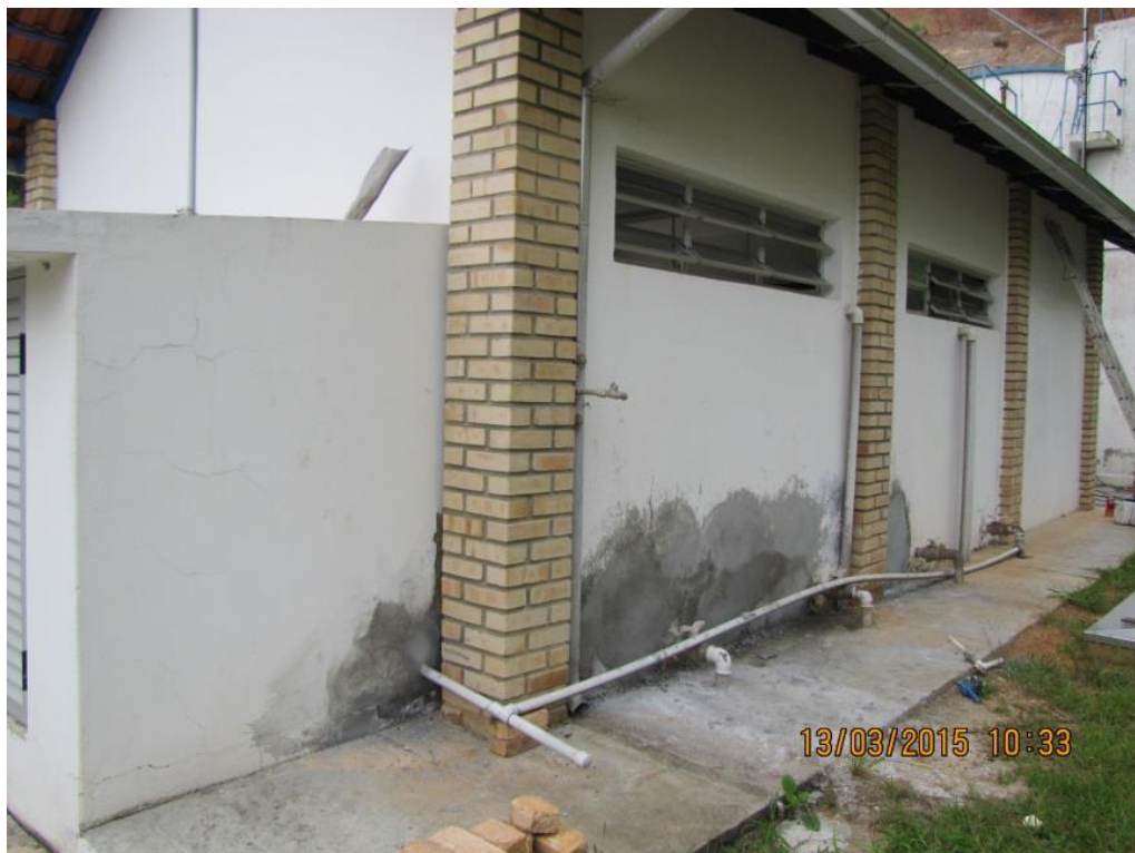
Figura 25 – ETA Zantão: Tubulação de tanque de contenção de vazamentos ligada diretamente em caixa de drenagem - não conformidade
