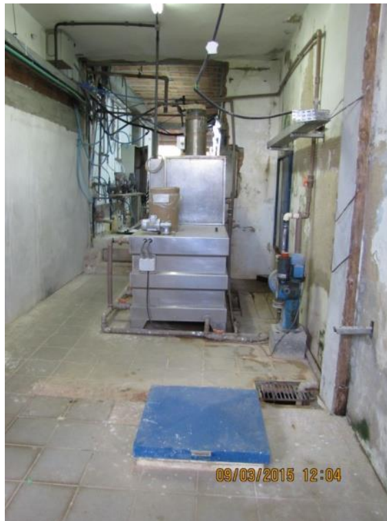
Figura 03 – ETA Central: Fiação de instalações elétricas dispostas de forma inadequada com situações de risco - não conformidade
