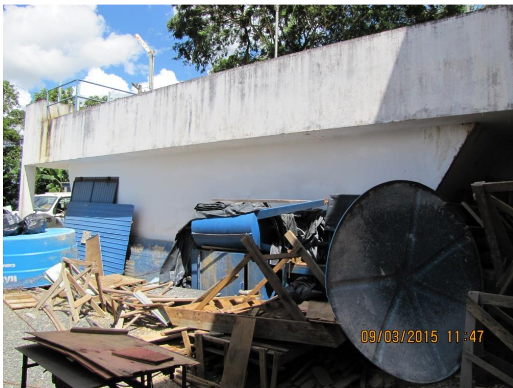
Figura 04 – ETA Central: Materiais de obra da ETA dispostos inadequadamente no entorno da estação – não conformidade
