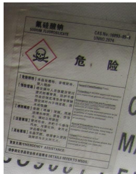
Figura 06 – ETA Central: Detalhe da ausência de etiquetas com tradução para o português em embalagem de produtos químicos - não conformidade
