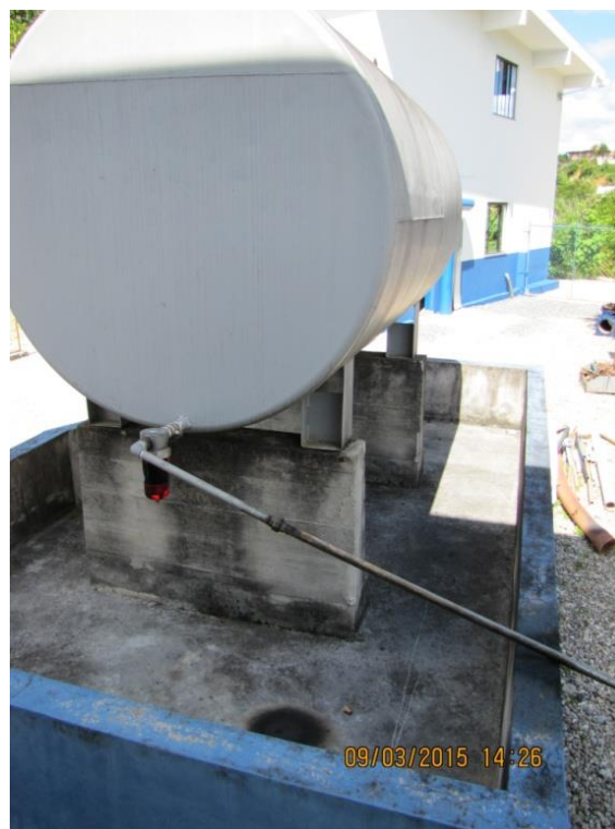
Figura 09 – Captação ETA Central: Registro de saída de tanque de contenção encontrado aberto comprometendo a sua função de reter vazamento de produtos químicos (Combustível do gerador de energia) - não conformidade
