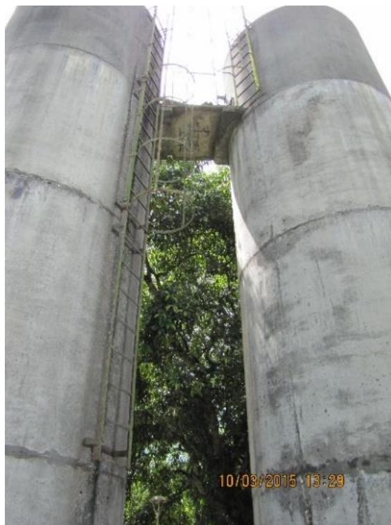
Figura 23 – ETA Central: Passarela entre reservatórios de água de retrolavagem dos filtros sem guarda-corpo de segurança - não conformidade
