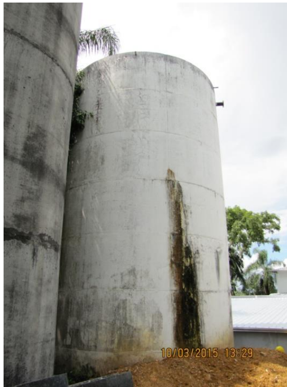
Figura 10 – ETA Central: Ausência de registro de manutenção e limpeza dos reservatórios de lavagem dos filtros - não conformidade
