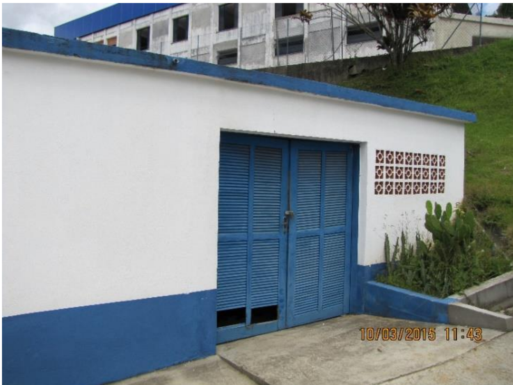
Figura 21 – ETA Central: Porta de acesso à casa de bombas danificada - não conformidade
