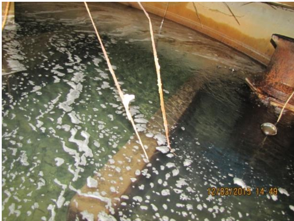
Figura 12 - ETA Santa Luzia: Detalhe da presença de espuma na superfície da água tratada do reservatório indicando possíveis problemas de operação - não conformidade
