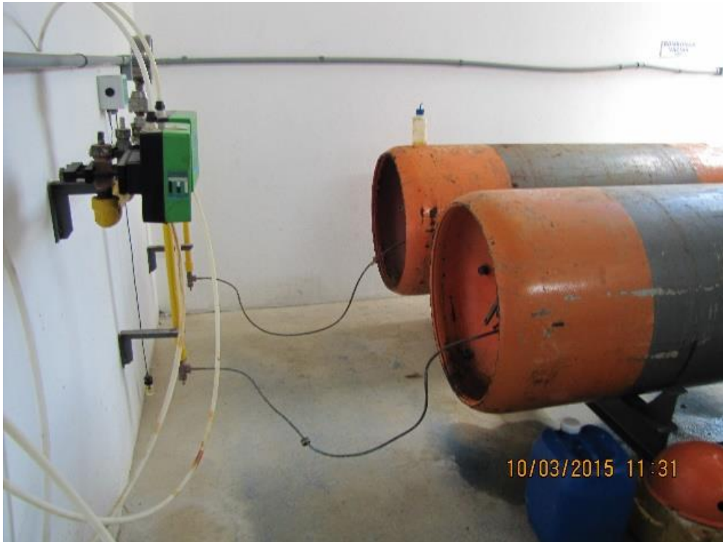
Figura 20 – ETA Central: Instalações para abastecimento de cloro gás (tubos de cobre) desprotegida e aparente. Ausência de sistema de contenção contra vazamentos e neutralizador de gás - não conformidade
