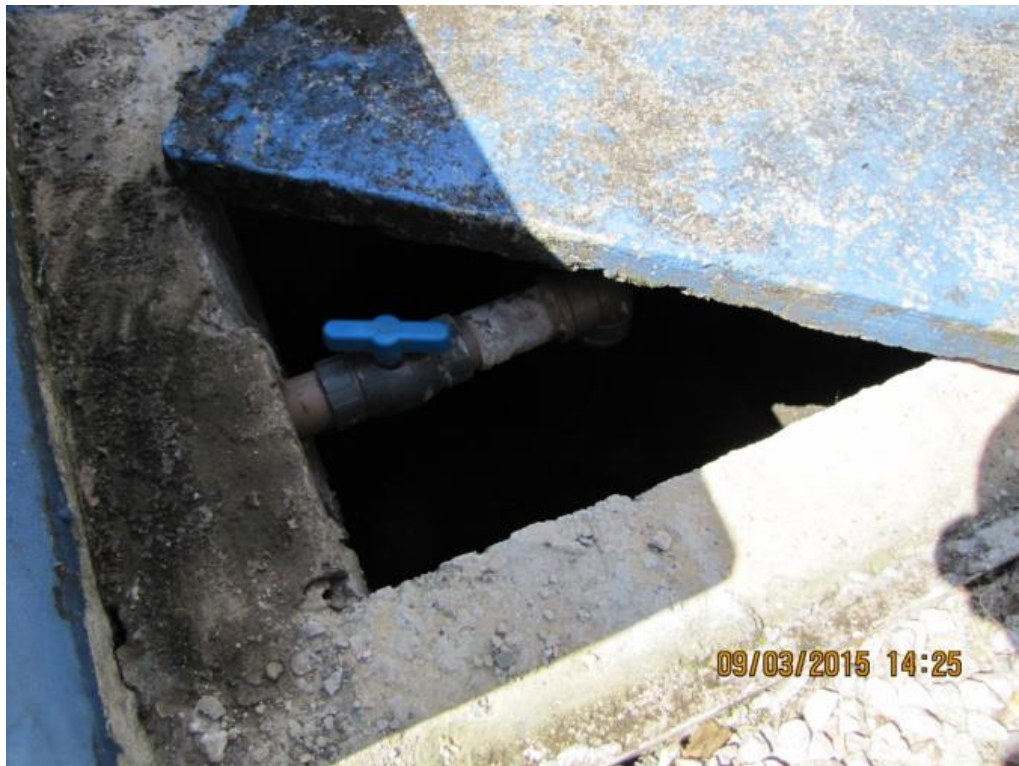
Figura 10 – Captação ETA Central: Detalhe do registro de saída de tanque de contenção encontrado aberto comprometendo a sua função de reter vazamento de produtos químicos - não conformidade
