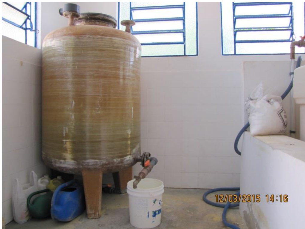
Figura 24 – ETA Santa Luzia: Tanque de cloro sem bacia de contenção de vazamento - não conformidade
