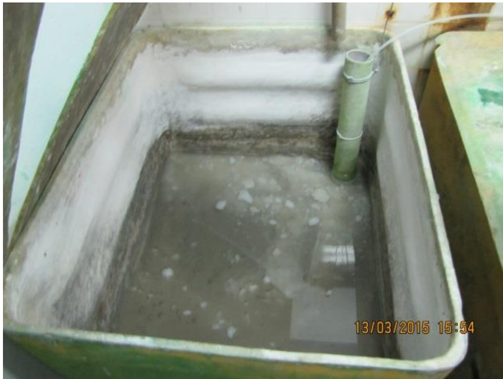
Figura 16 - ETA Bateas: Reservatório de dosagem de flúor sem uso por problemas na bomba dosadora - não conformidade
