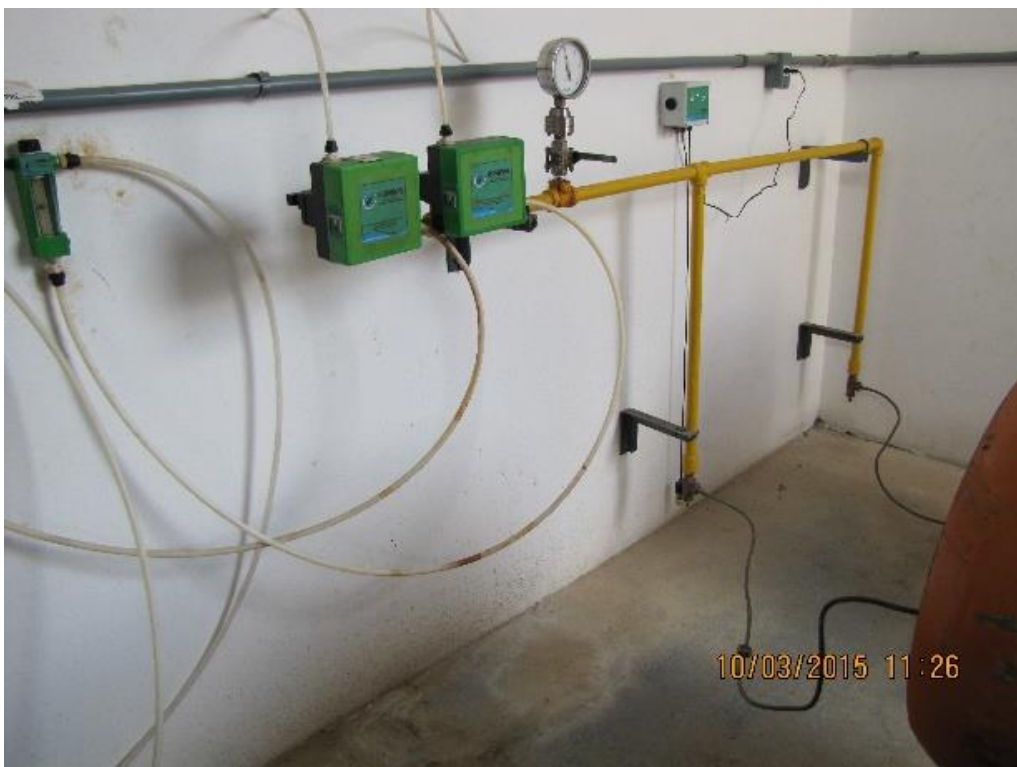
Figura 19 – ETA Central: Instalações para abastecimento de cloro gás (tubos de cobre) desprotegida e aparente - não conformidade
