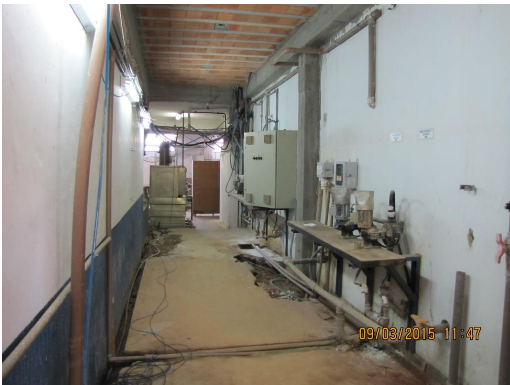
Figura 02 – ETA Central: Fiação de instalações elétricas dispostas de forma inadequada com situações de risco - não conformidade
