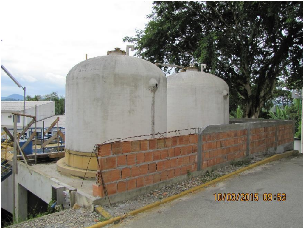
Figura 18 – ETA Central: Tanque de produtos químicos sem bacia de contenção de vazamentos - não conformidade
