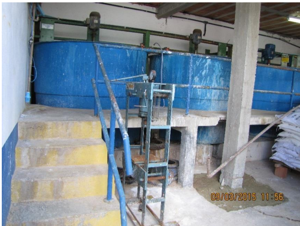
Figura 17 - ETA Central: Tanque de dosagem de produtos químicos sem bacia de contenção de vazamentos - não conformidade
