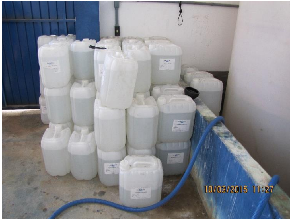
Figura 22 – ETA Central: Bombonas com produtos químicos armazenados fora do tanque de contenção - não conformidade
