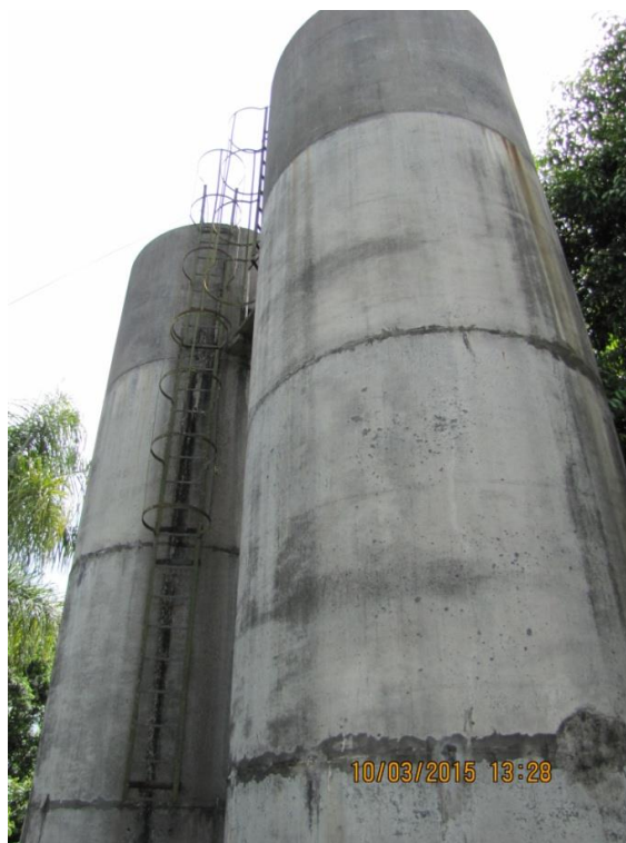
Figura 09 – ETA Central: Ausência de registro de manutenção e limpeza dos reservatórios de lavagem dos filtros - não conformidade
