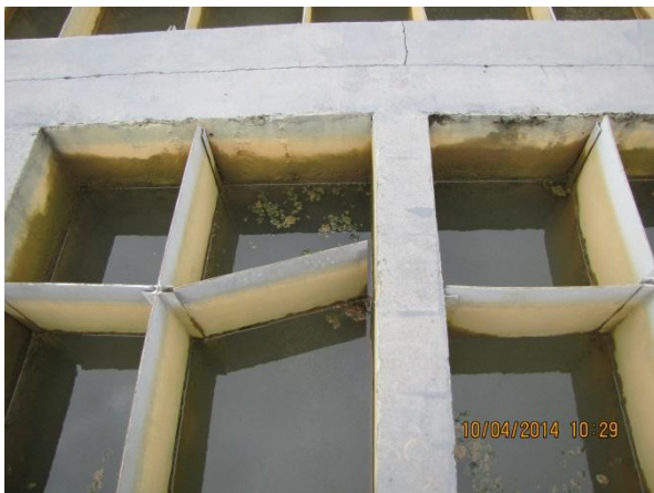
Figura 31 – ETA: Detalhe da placa do floculador danificada e com ausência de manutenção – não conformidade
