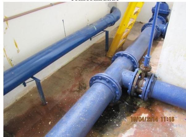
Figura 58 – ETA: Presença de vazamento nos registros de manobra – não conformidade
