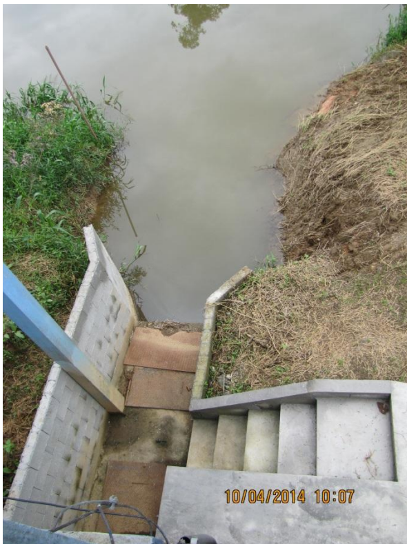
Figura 9 – Captação: Ponto de captação com escada de acesso sem corrimão e guarda-corpo de segurança para os operadores – não conformidade
