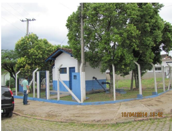
Figura 110 – Estação Elevatória: Vista geral da Estação Elevatória localizada na Rua Groelândia, Bairro Nações Ausência de placa de identificação da autarquia – não conformidade
