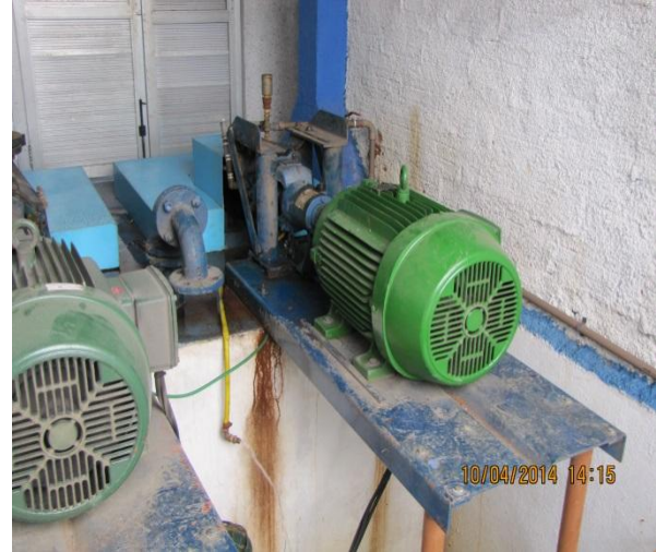
Figura 127 – Estação Elevatória: Presença de vazamentos em grande quantidade nas motobombas – não conformidade Travamento adequado das motobombas – conformidade Presença de motobomba reserva em paralelo para acionamento imediato em casos de emergência – conformidade
