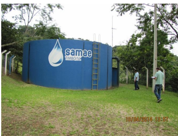
Figura 169 – Reservatório: Pintura de identificação da autarquia - conformidade Escada de acesso com ausência de gaiola de proteção para os operadores – não conformidade
