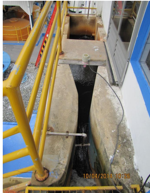
Figura 26 – ETA: Entrada de água bruta. Calha Parshall, dosagem de reagente e agitação hidráulica - conformidade
