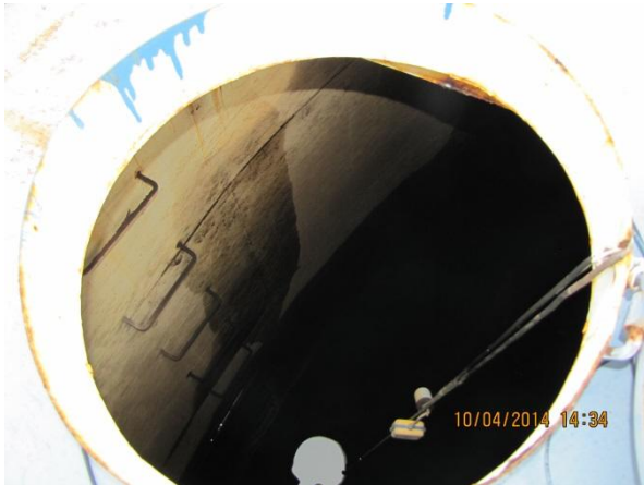
Figura 183 – Reservatório: Parede e escada de acesso interna em boas condições – conformidade Medição de nível - conformidade
