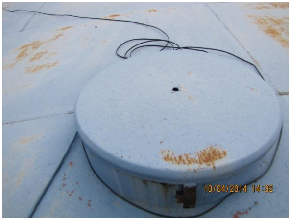
Figura 181 – Reservatório: Tampa de inspeção com ausência de travamento adequado (cadeado) – não conformidade
