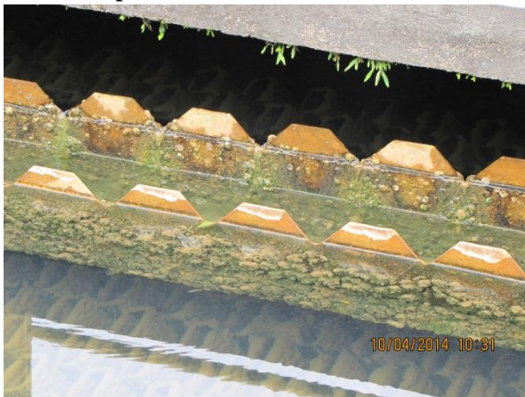
Figura 35 – ETA: Detalhe da ausência de higiene e limpeza das calhas vertedoras do decantador – não conformidade
