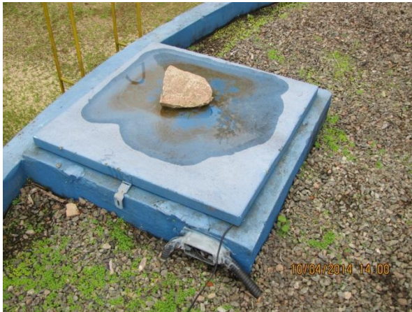
Figura 171 – Reservatório: Tampa de inspeção sem travamento adequado (cadeado) – não conformidade
