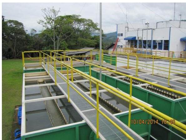
Figura 49 – ETA: Vista geral dos decantadores – conformidade Passarelas com guarda-corpo de proteção para os operadores em boas condições - conformidade
