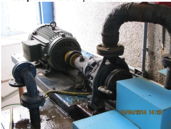
Figura 136 – Estação Elevatória: Ausência de proteção mecânica na motobomba – não conformidade Tubulação em estado avançado de oxidação – não conformidade
