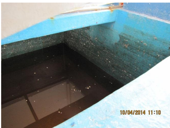
Figura 67 – ETA: Detalhe da ausência de limpeza do interior do tanque de dosagem, presença de partículas suspensas e decantadas - não conformidade
