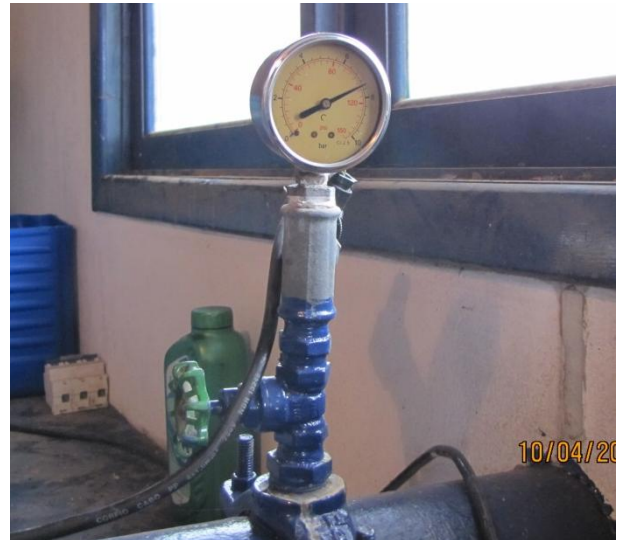
Figura 147 – Estação Elevatória: Sistema de medição para controle da pressão indicando aprox. 70 mca (40% acima do preconizado em norma) – não conformidade
