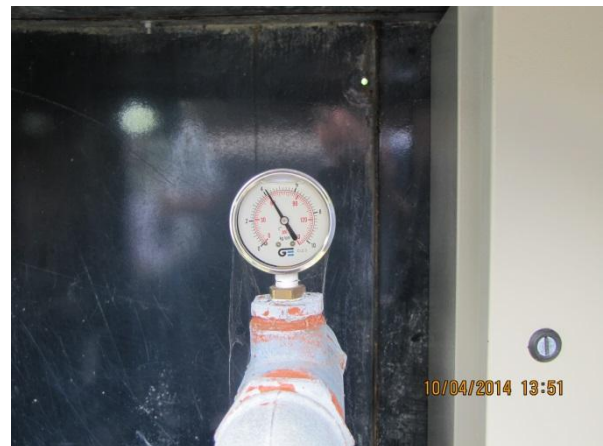
Figura 119 – Estação Elevatória: Sistema de medição para controle da pressão indicando aprox. 40 mca – conformidade
