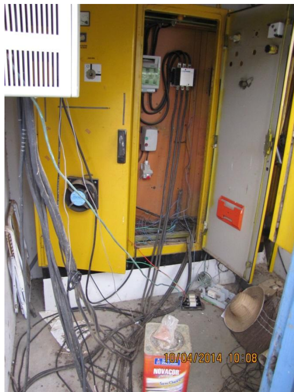
Figura 12 – Captação: Quadro de comando com instalação elétrica aparente e dificuldade de circulação – não conformidade
