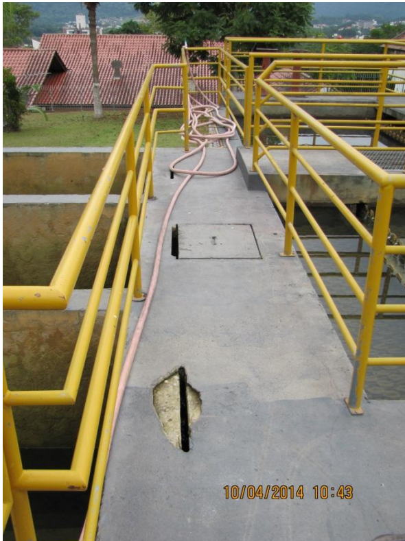
Figura 39 – ETA: Presença de aberturas na passarela que dá acesso aos filtros – não conformidade
