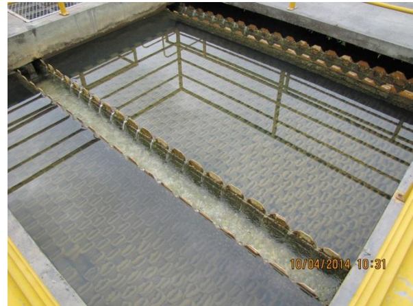
Figura 34 – ETA: Vista geral do decantador e calhas vertedoras
