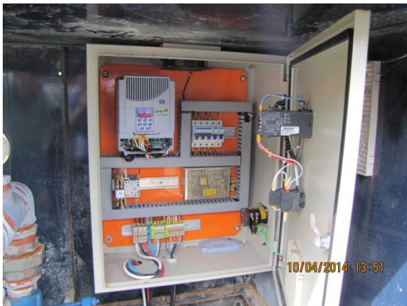
Figura 118 – Estação Elevatória: Presença de inversor de frequência - conformidade
