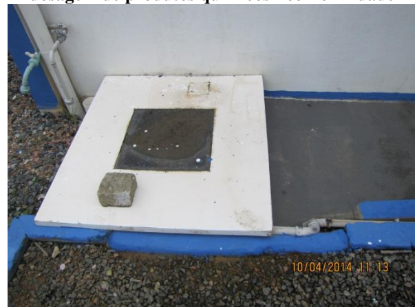
Figura 54 – ETA: Detalhe tampa de inspeção do tanque de contato Ausência de travamento satisfatório – não conformidade
