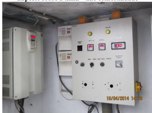
Figura 133 – Estação Elevatória: Quadros de comando e força em boas condições – conformidade Presença de inversor de frequência - conformidade
