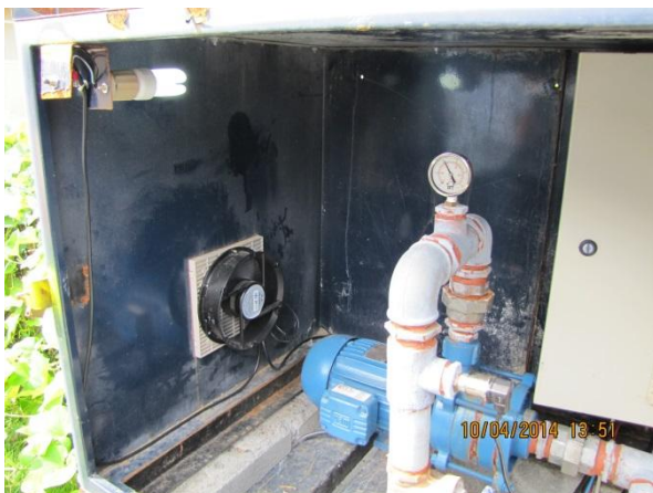
Figura 120 – Estação Elevatória: Exaustor para controle da temperatura e sistema de iluminação para trabalhos de manutenção noturnos - conformidade
