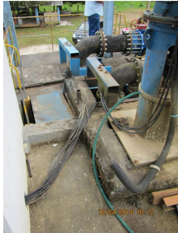
Figura 16 – Captação: Instalações elétricas aparentes e desprotegidas – não conformidade
