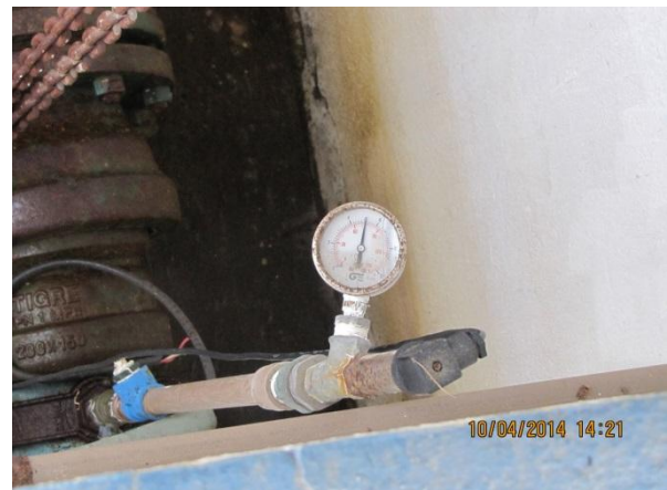
Figura 137 – Estação Elevatória: Sistema de medição para controle da pressão indicando aprox. 50 mca – conformidade
