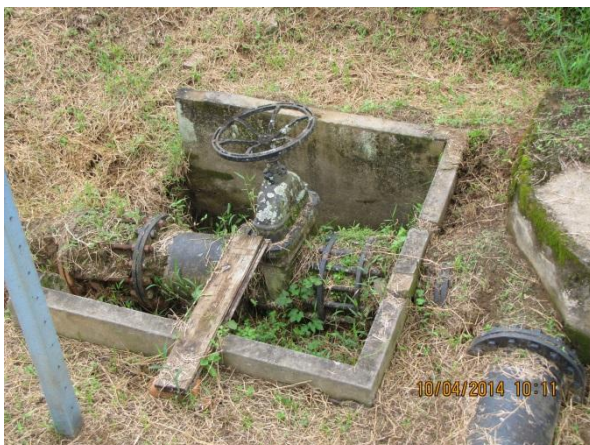
Figura 21 – ETA: Ausência de acesso adequado para operação/manutenção do registro de manobra da adutora de água bruta – não conformidade
