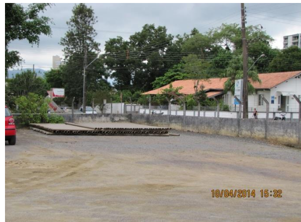
Figura 219 – Escritório Operacional: Empilhamento correto das tubulações, porém ausência de estrado de madeira – não conformidade
