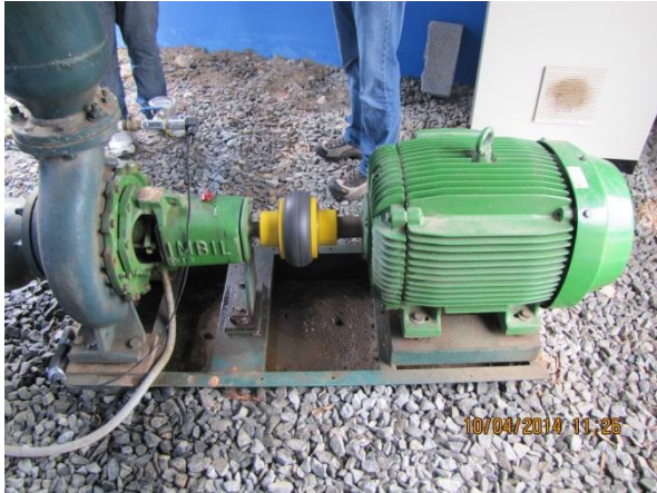
Figura 150 – Estação Elevatória ETA: Ausência de proteção mecânica na motobomba – não conformidade Travamento adequado da motobomba – conformidade
