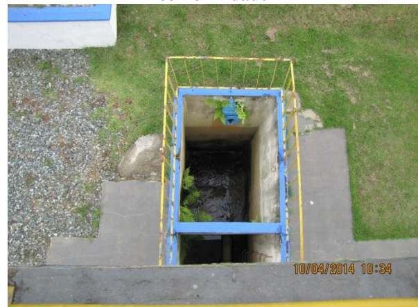
Figura 38 – ETA: Detalhe do descarte de fundo dos decantadores sem destinação e tratamento adequado – não conformidade
