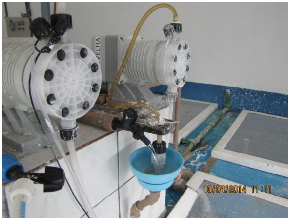
Figura 65 – ETA: Detalhe da adaptação do sistema de dosagem do produto químico – conformidade
