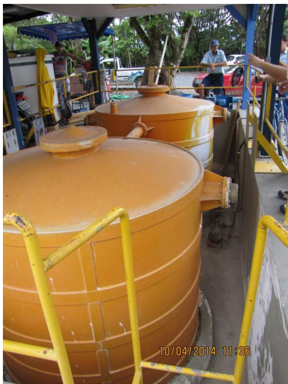
Figura 71 – ETA: Detalhe das instalações dos tanques de produtos químicos - conformidade
