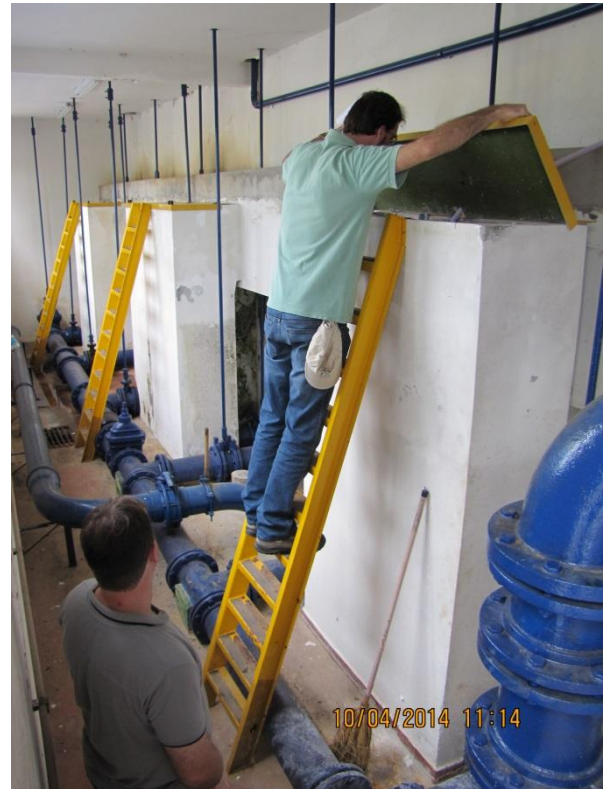
Figura 56 – ETA: Vista geral da saída dos filtros - conformidade
