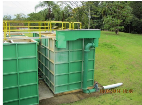
Figura 46 – ETA: Detalhe da adutora de água bruta - conformidade
