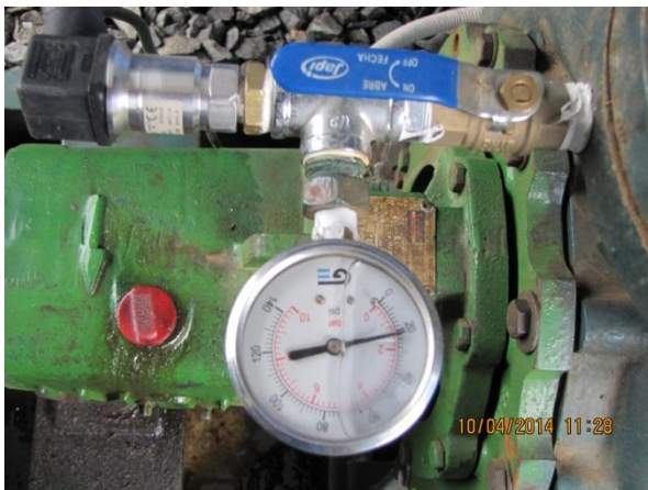
Figura 152 – Estação Elevatória ETA: Sistema de medição para controle da pressão indicando aprox. 15 mca – conformidade
