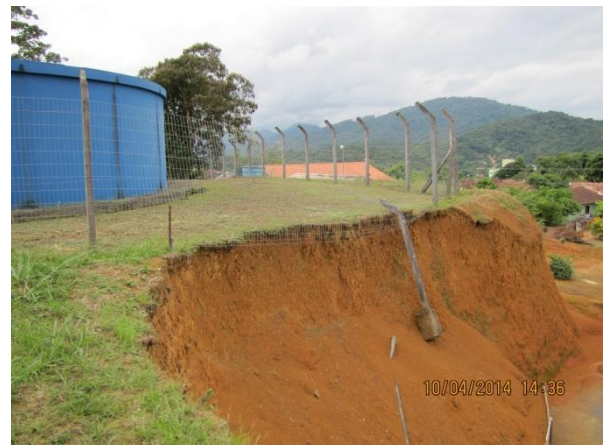
Figura 178 – Reservatório: Cerca de isolamento danificada pelo desmoronamento do talude – não conformidade
