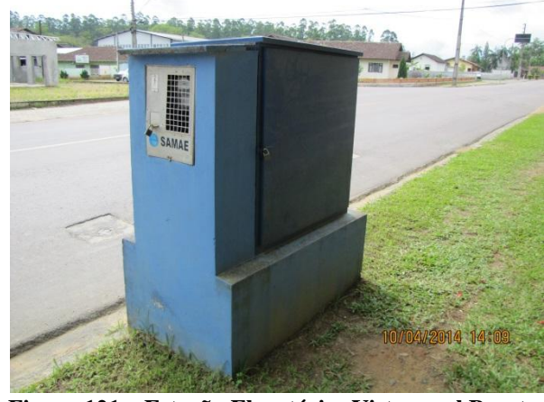
Figura 121 – Estação Elevatória: Vista geral Booster Pomeranos Placa de identificação da autarquia – conformidade Cadeado para travamento da porta de acesso - conformidade
