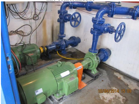
Figura 140 – Estação Elevatória: Presença de motobomba reserva em paralelo para acionamento imediato em casos de emergência – conformidade Travamento adequado das motobombas – conformidade
