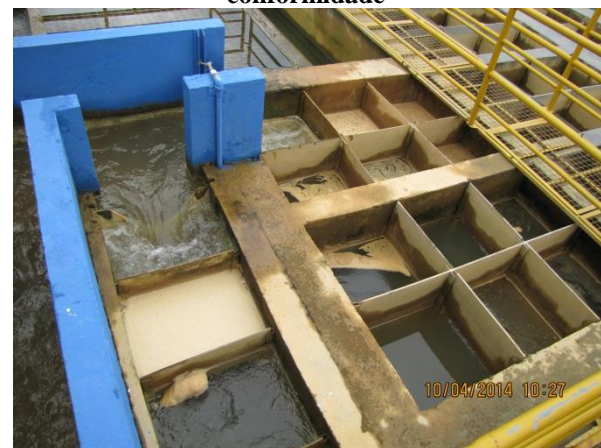
Figura 28 – ETA: Vista geral do floculador hidráulico - conformidade
