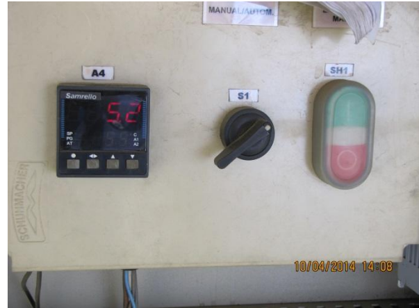
Figura 123 – Estação Elevatória: Sistema de medição para controle da pressão indicando aprox. 52 mca – conformidade
