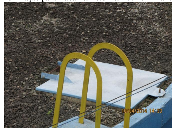
Figura 186 – Reservatório: Tampa de inspeção sem travamento adequado (cadeado) e escada sem gaiola de proteção – não conformidade
