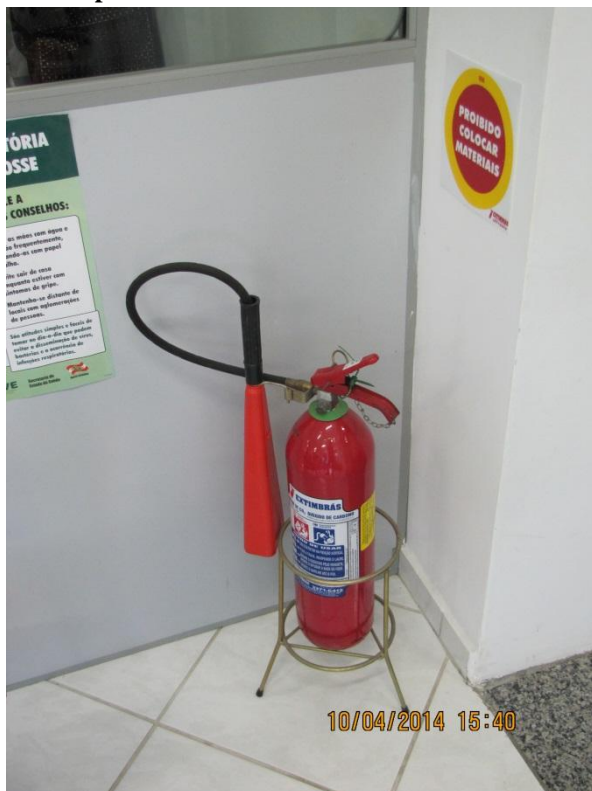
Figura 233 – Atendimento ao Cliente: Extintor de incêndio - conformidade
