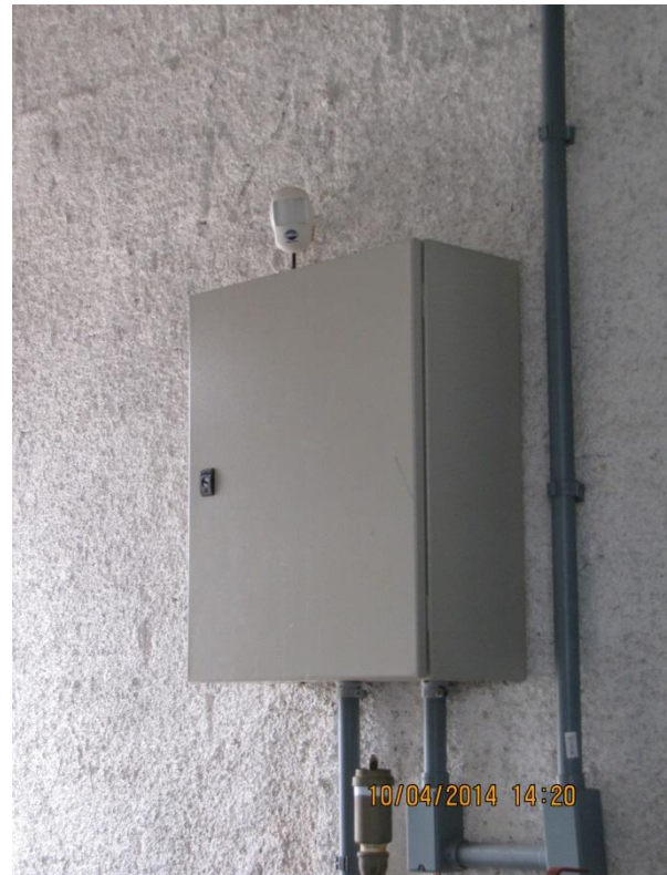
Figura 135 – Estação Elevatória: Sensor infravermelho para segurança - conformidade
