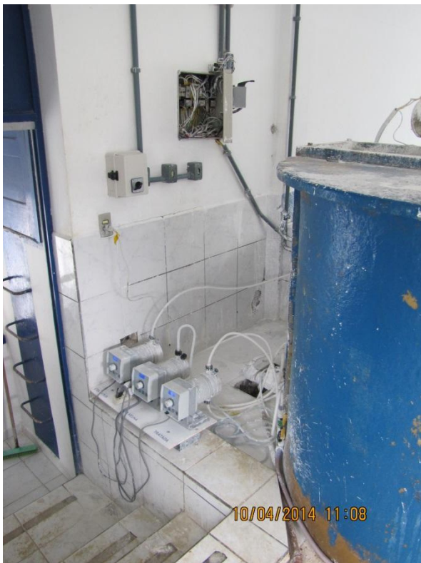
Figura 61 – ETA: Instalações elétricas aparentes – não conformidade
