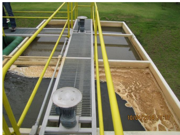
Figura 48 – ETA: Vista geral dos flocculadores mecânicos - conformidade
