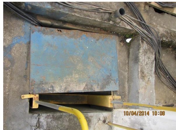
Figura 10 – Captação: Tampa de inspeção/proteção do poço de bombeamento não satisfatória, sem manutenção e travamento adequado (cadeado) – não conformidade
