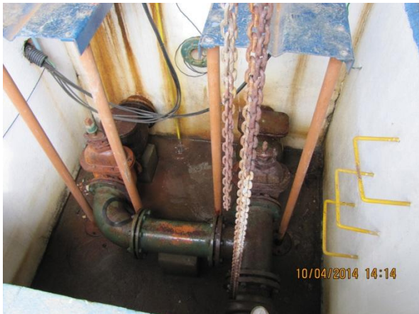
Figura 128 – Estação Elevatória: Detalhe dos vazamentos em grande quantidade das motobombas – não conformidade Registros de manobra e tubulações em estado avançado de oxidação – não conformidade
