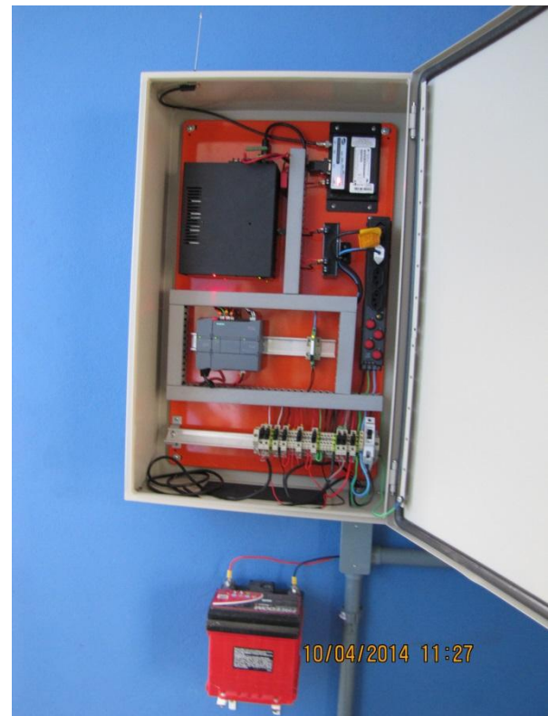
Figura 151 – Estação Elevatória ETA: Quadro de comando e inversor de frequência em boas condições - conformidade
