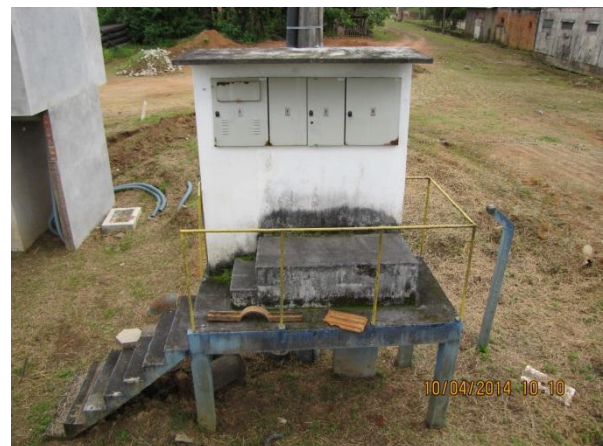
Figura 20 – Captação: Quadros de força em boas condições – conformidade
