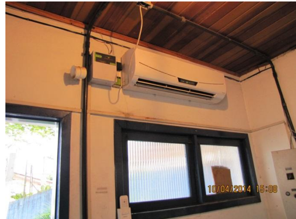
Figura 145 – Estação Elevatória: Sistema de refrigeração para controle interno da temperatura - conformidade
