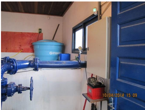
Figura 146 – Estação Elevatória: Sensor infravermelho para segurança – conformidade Detalhe do sistema de dosagem de reagente para a desincrustação de redes, controle de corrosão, de cor e de turbidez – conformidade
