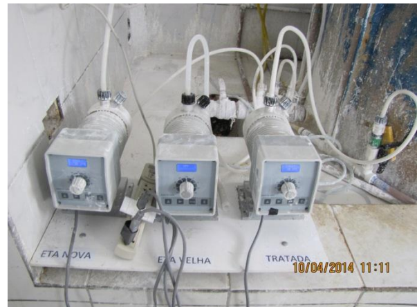
Figura 62 – ETA: Detalhe das bombas dosadoras
