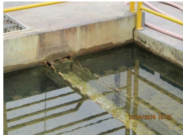
Figura 36 – ETA: Detalhe dos tijolos improvisados na calha vertedora do decantador – não conformidade
