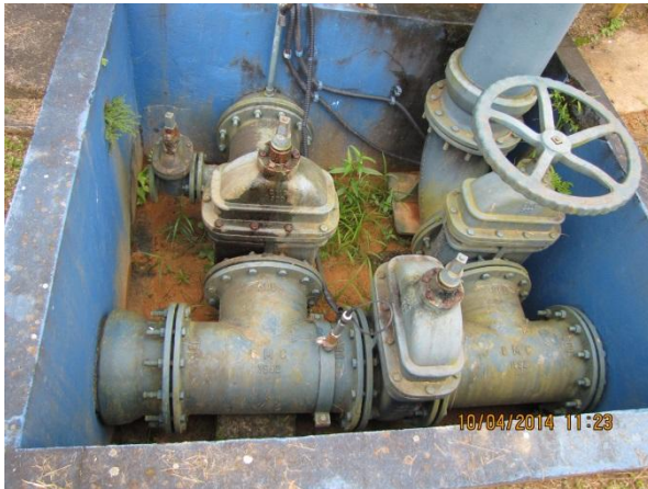
Figura 159 – Reservatório ETA: Registro de manobra oxidado e com vazamentos – não conformidade
