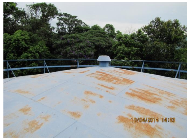
Figura 182 – Reservatório: Tubo de ventilação e guarda-corpo de segurança – conformidade Pintura desgastada e estrutura metálica com presença de oxidação – não conformidade
