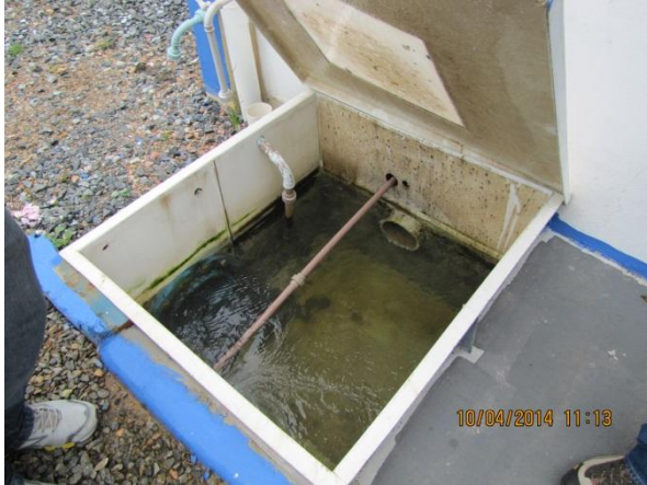
Figura 55 – ETA: Detilhe da entrada do tanque de contato com ausência de higiene e limpeza satisfatória – não conformidade
