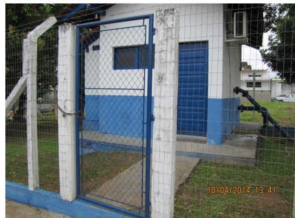
Figura 111 – Estação Elevatória: Presença de cerca de isolamento e cadeado/corrente para travamento do portão de acesso - conformidade
