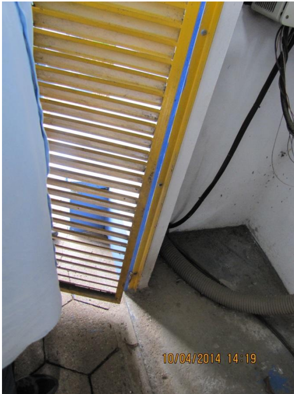
Figura 134 – Estação Elevatória: Portão de acesso aos quadros de comando com ausência de fixação adequada e manutenção – não conformidade
