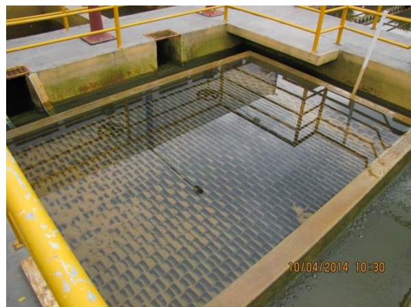
Figura 32 – ETA: Vista geral do decantador
