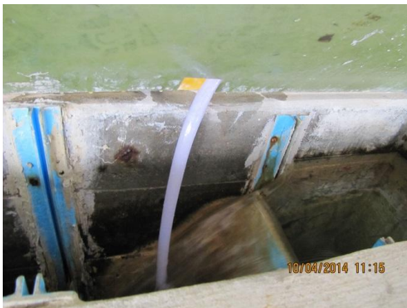
Figura 57 – ETA: Detilhe da dosagem de reagente na saída do filtro - conformidade
