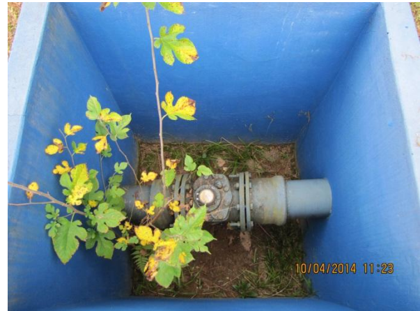
Figura 160 – Reservatório ETA: Macromedidor - conformidade
