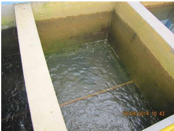
Figura 41 – ETA: Detalhe do filtro - conformidade
