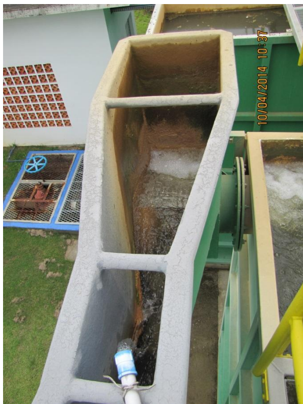
Figura 47 – ETA: Detalhe da Calha Parshall e dosagem de reagente - conformidade
