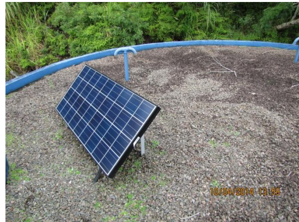
Figura 172 – Reservatório: Pannel solar e tubos de ventilação - conformidade
