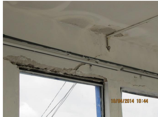
Figura 44 – ETA: Detalhe da estrutura danificada das instalações dos registros de manobra – não conformidade
