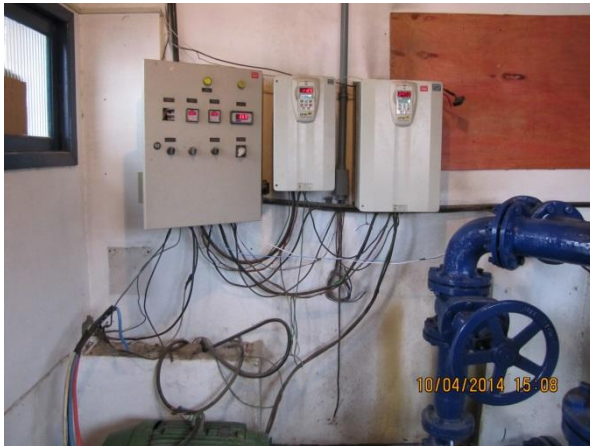
Figura 144 – Estação Elevatória: Instalações elétricas aparentes e desprotegidas – não conformidade
