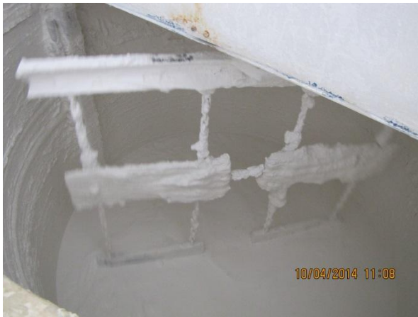
Figura 63 – ETA: Detalhe do tanque de dosagem do produto químico - conformidade
