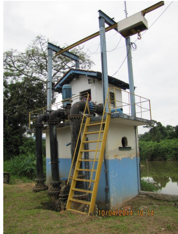
Figura 8 – Captação: Talha e guincho para instalação/manutenção das bombas - conformidade
