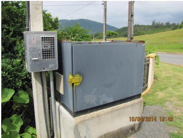
Figura 116 – Vista geral Booster Ausência de placa de identificação da autarquia – não conformidade Cadeado para travamento da porta de acesso - conformidade
