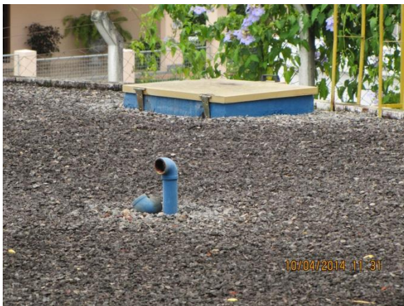
Figura 163 – Reservatório ETA: Tubos de ventilação danificados e com ausência de tela de proteção – não conformidade
