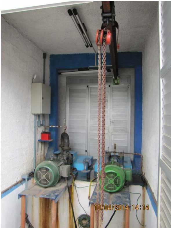
Figura 126 – Estação Elevatória: Vista geral das instalações internas Iluminação para trabalhos noturnos - conformidade
