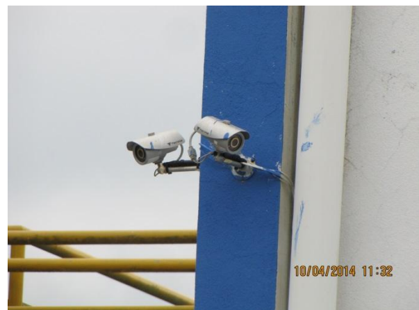
Figura 164 – Reservatório: Câmeras de segurança - conformidade
