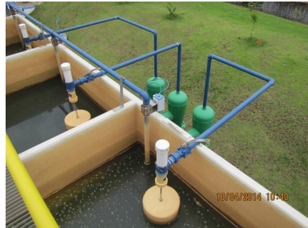
Figura 52 – ETA: Detalhe do filtro e sistema de dosagem de produtos químicos - conformidade
