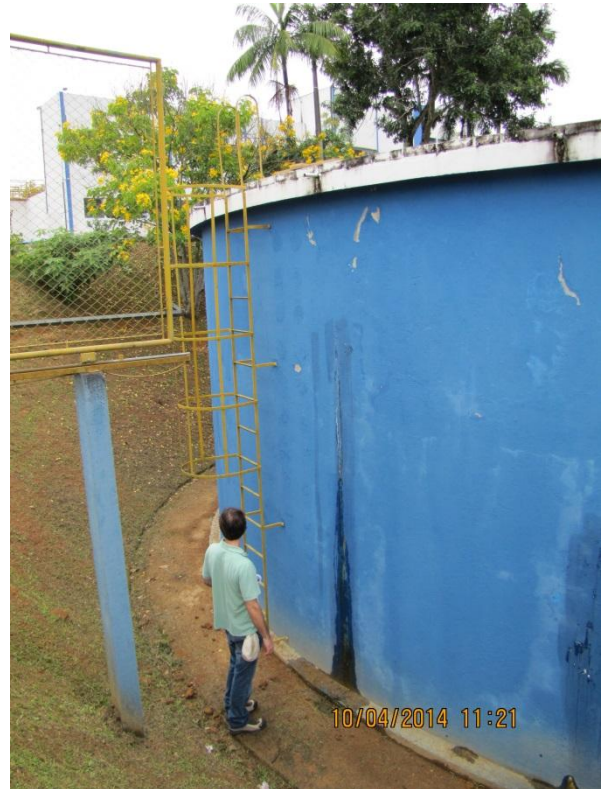
Figura 156 – Reservatório ETA: Detalhe da escada de acesso com gaiola de proteção para os operadores - conformidade
