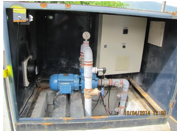
Figura 117 – Estação Elevatória: Vista geral Quadros de comando e força em boas condições – conformidade Travamento adequado do booster – conformidade
