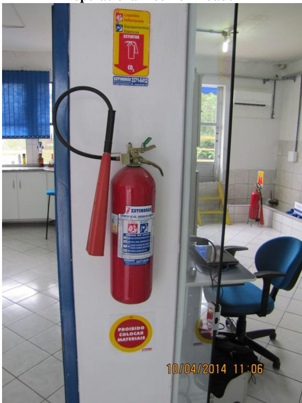
Figura 87 – ETA: Extintores de incêndio nos laboratórios - conformidade
