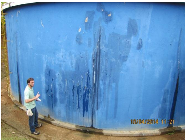
Figura 157 – Reservatório ETA: Presença de pequenas fissuras causando vazamentos na parede do reservatório – não conformidade
