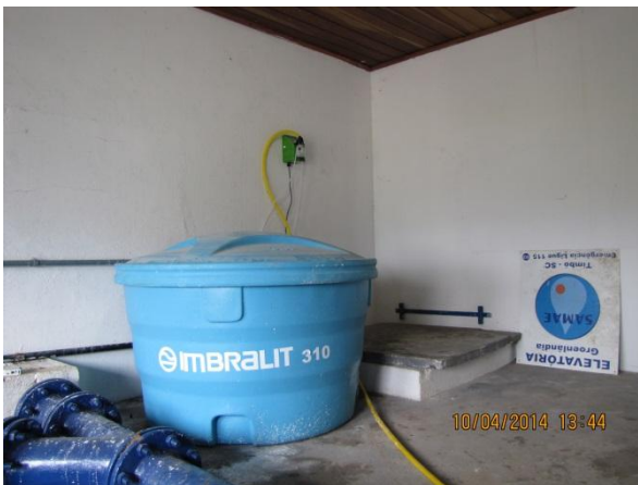
Figura 114 – Estação Elevatória: Detalhe do sistema de dosagem de reagente para a desincrustação de redes, controle de corrosão, de cor e de turbidez – conformidade Ausência de fixação adequada da placa de identificação da estação elevatória – não conformidade
