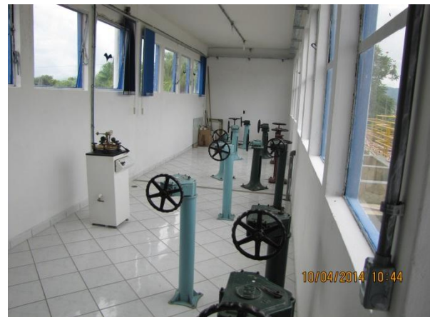
Figura 42 – ETA: Detalhe dos registros de manobra - conformidade
