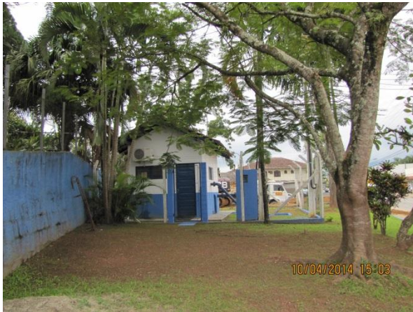
Figura 138 – Estação Elevatória: Vista geral da Estação Elevatória localizada na Rua Blumenau, Bairro Estados Ausência de placa de identificação da autarquia – não conformidade
