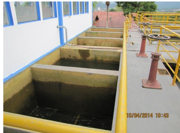
Figura 40 – ETA: Vista geral dos filtros - conformidade
