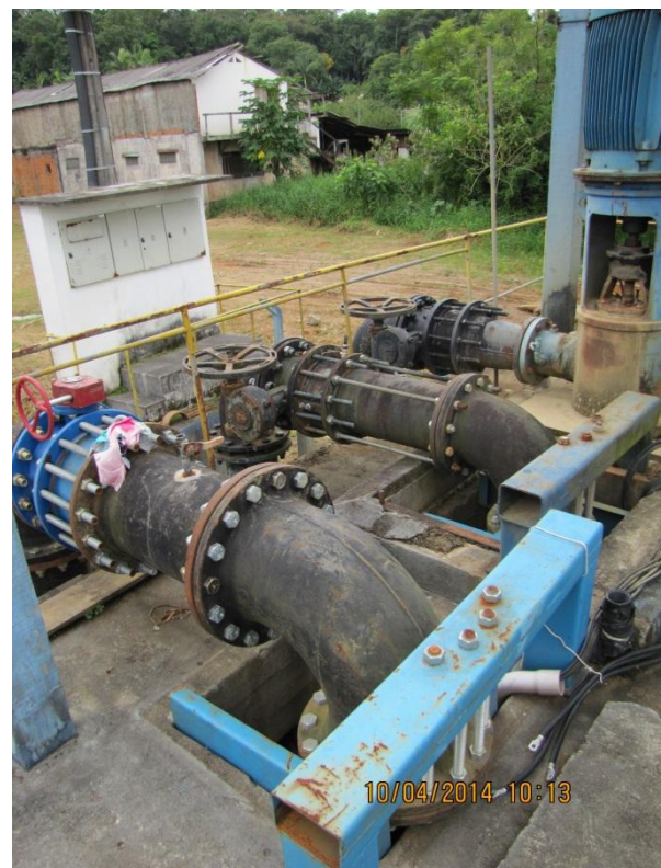
Figura 18 – Captação: Vista geral do sistema de bombeamento - conformidade
