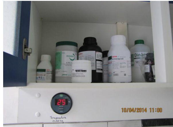
Figura 100 – ETA: Armazenagem dos produtos químicos em boas condições e com controle de temperatura - conformidade
