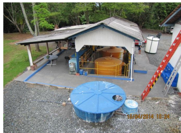
Figura 68 – ETA: Vista geral das instalações dos tanques de produtos químicos - conformidade
