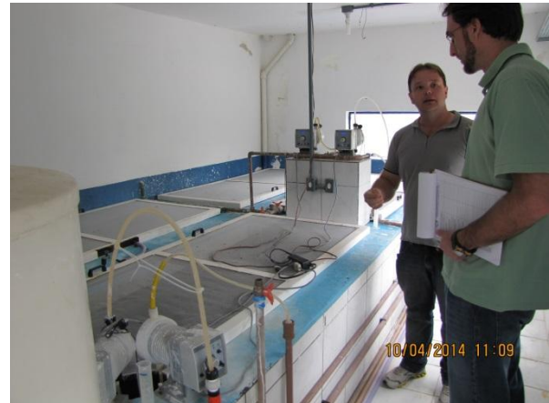
Figura 66 – ETA: Vista geral da Casa de Química Identificação, tampas e telas de proteção nos tanques de dosagem - conformidade
