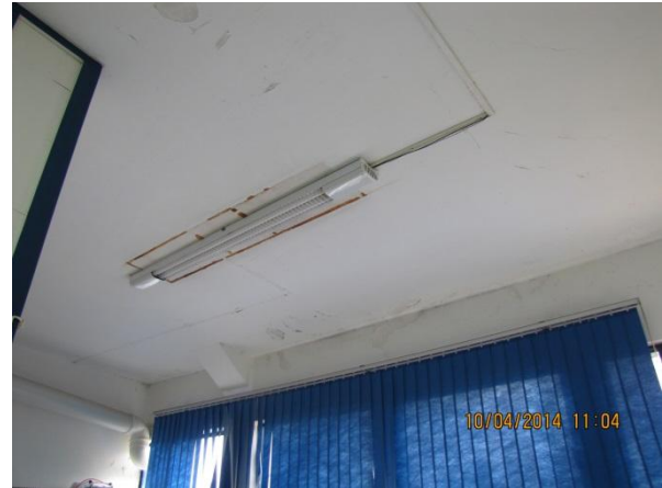
Figura 90 – ETA: Ausência de conservação e pintura adequada das paredes do laboratório – não conformidade
