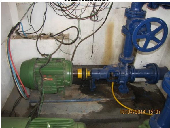
Figura 142 – Estação Elevatória: Ausência de proteção mecânica na motobomba – não conformidade
