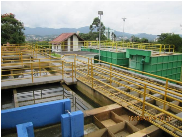
Figura 29 – ETA: Vista geral dos floculadores Sistema de iluminação para trabalhos noturnos – conformidade Passarelas principais com guarda-corpo de segurança para os operadores - conformidade
