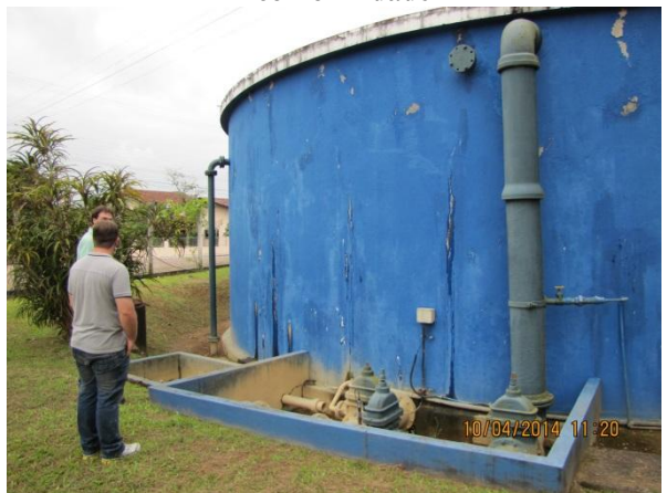
Figura 158 – Reservatório ETA: Tubo extravasor, caixa de descarga e registros de manobra - conformidade
