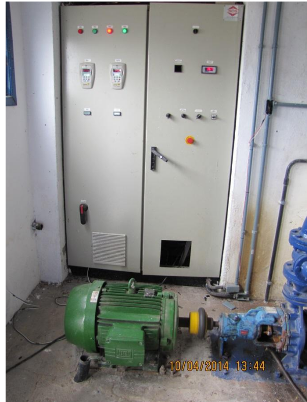
Figura 113 – Estação Elevatória: Ausência de proteção mecânica na motobomba – não conformidade Quadros de comando e força em boas condições – conformidade
