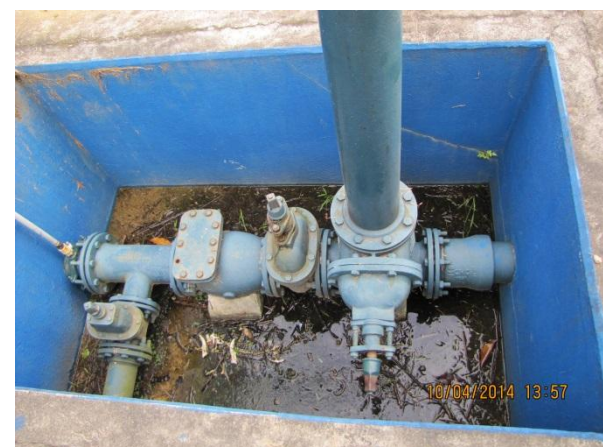
Figura 170 – Reservatório: ausência de manutenção de limpeza do dreno das águas pluviais – não conformidade
