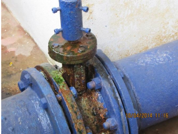
Figura 59 – ETA: Detalhe do vazamento e oxidação do registro de manobra – não conformidade
