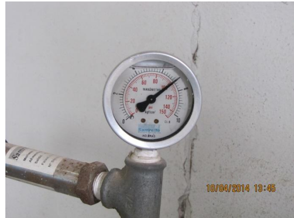
Figura 115 – Estação Elevatória: Sistema de medição para controle da pressão indicando aprox. 70 mca (40% acima do preconizado em norma) – não conformidade
