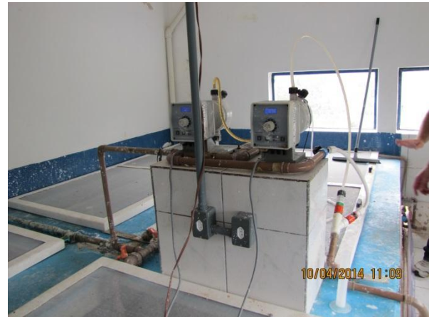
Figura 64 – ETA: Bomba dosadora em paralelo para acionamento imediato em casos de emergência - conformidade
