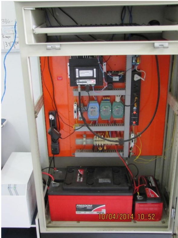
Figura 85 – ETA: Detalhe do sistema informatizado de telemetria e do controle operacional - conformidade
