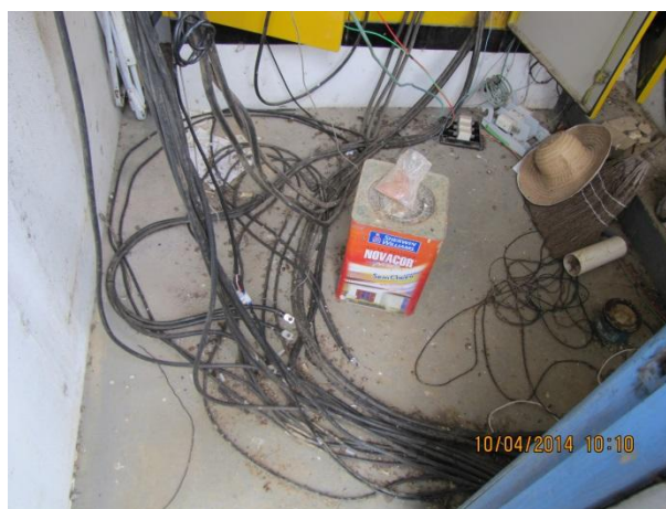
Figura 14 – Captação: Detalhe das instalações elétricas aparentes, ausência de manutenção e limpeza – não conformidade
