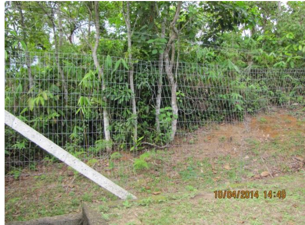
Figura 194 – Reservatório: Cerca de isolamento danificada e com ausência de manutenção – não conformidade
