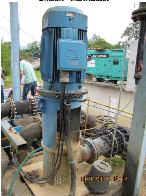
Figura 17 – Captação: Bomba reserva em paralelo para acionamento imediato em casos de emergência - conformidade
