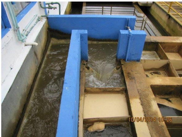
Figura 27 – ETA: Detalhe da entrada de água bruta no floculador - conformidade
