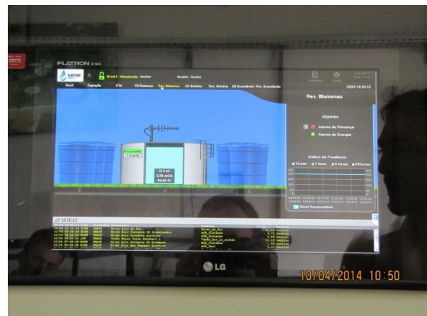
Figura 84 – ETA: Detalhe do sistema informatizado de telemetria e do controle operacional dos reservatórios - conformidade
