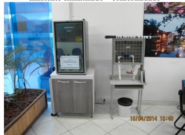
Figura 230 – Atendimento ao Cliente: Água disponível para os usuários e funcionários - conformidade
