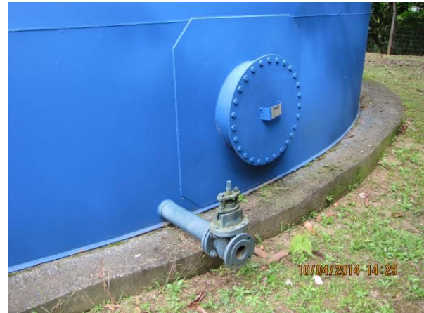
Figura 180 – Reservatório: Registro e tubulação de descarte de fundo para higienização do reservatório - conformidade
