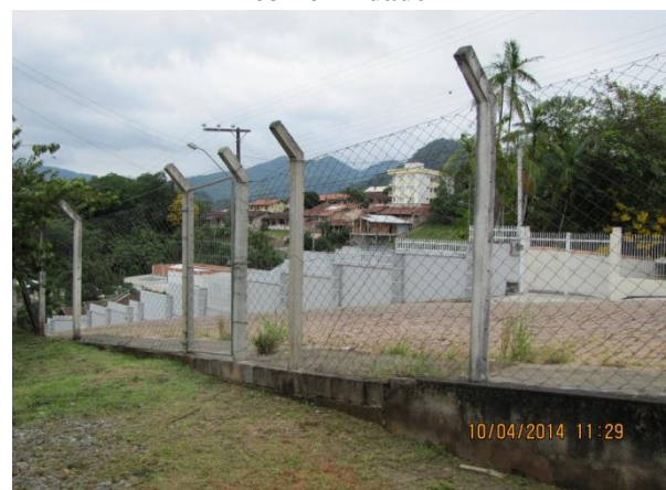
Figura 149 – Estação Elevatória ETA: Presença de cerca de isolamento e travamento adequado do portão de acesso - conformidade
