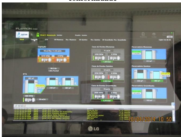
Figura 83 – ETA: Detalhe do sistema informatizado de telemetria e do controle operacional das Estações Elevatórias - conformidade
