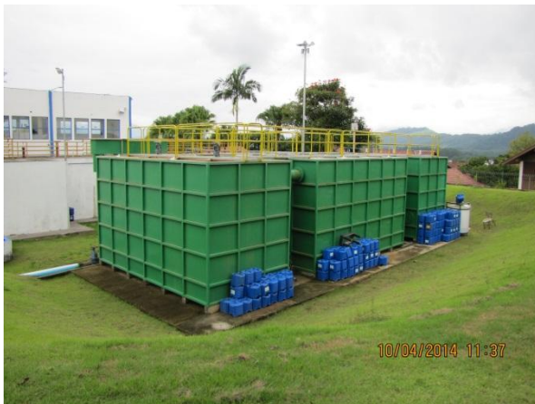
Figura 45 – Vista geral da ETA Compacta
