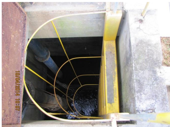
Figura 11 – Captação: Escada de acesso ao poço de bombeamento em boas condições e com gaiola de proteção para os operadores - conformidade
