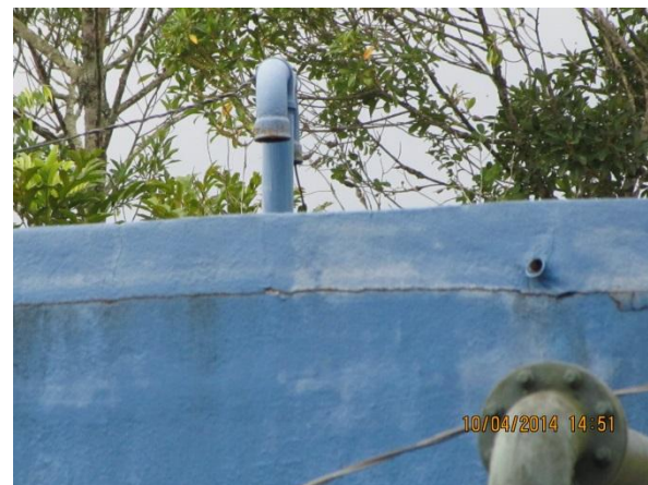
Figura 192 – Reservatório: Detalhe do tubo de ventilação sem tela de proteção – não conformidade
