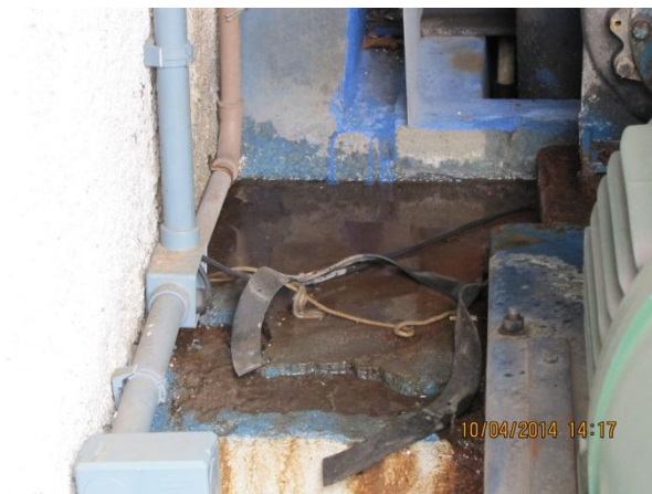
Figura 132 – Estação Elevatória: Instalações elétricas aparentes e expostas aos vazamentos das motobombas – não conformidade
