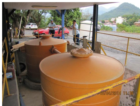
Figura 72 – ETA: Detalhe das instalações dos tanques de produtos químicos - conformidade
