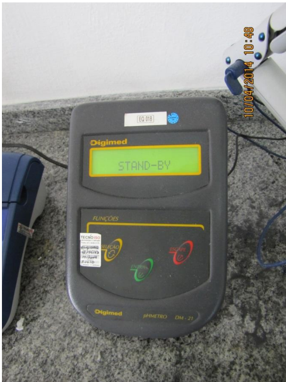
Figura 79 – ETA: Detalhe do pHmetro com etiqueta de controle de calibração dentro do prazo de validade - conformidade
