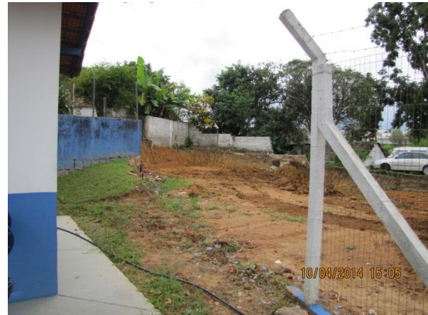
Figura 139 – Estação Elevatória: Cerca de isolamento danificada por obras do terreno vizinho – não conformidade
