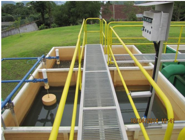
Figura 51 – ETA: Vista geral dos filtros - conformidade
