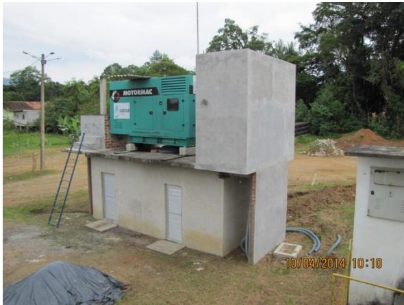
Figura 19 – Captação: Vista geral das instalações do gerador de energia – conformidade Escada de acesso para operação/manutenção do gerador não satisfatório – não conformidade
