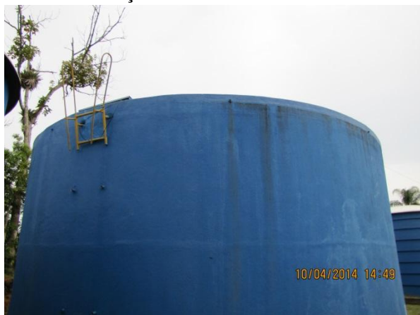
Figura 191 – Reservatório: Escada de acesso removível devido problemas de vandalismo no local - conformidade
