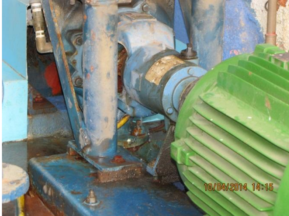
Figura 130 – Estação Elevatória: Detalhe do vazamento na motobomba – não conformidade
