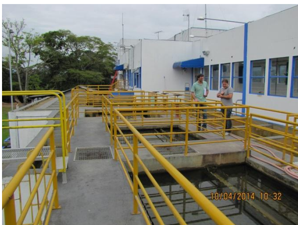
Figura 37 – ETA: Vista geral dos decantadores
