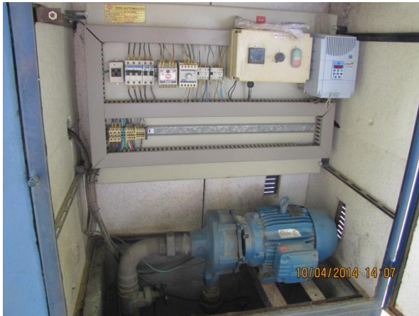
Figura 122 – Estação Elevatória: Vista geral Quadros de comando e força em boas condições – conformidade
