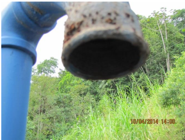
Figura 173 – Reservatório: Detalhe do tubo de ventilação sem tela de proteção – não conformidade
