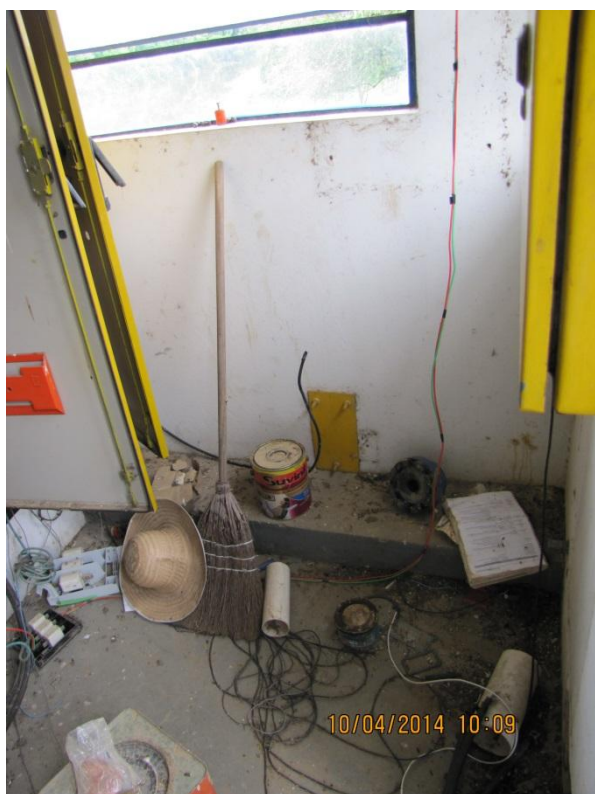
Figura 13 – Captação: Ausência de manutenção e limpeza das instalações – não conformidade
