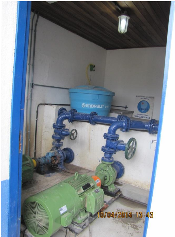
Figura 112 – Estação Elevatória: Vista geral Presença de motobomba reserva em paralelo para acionamento imediato em casos de emergência – conformidade
