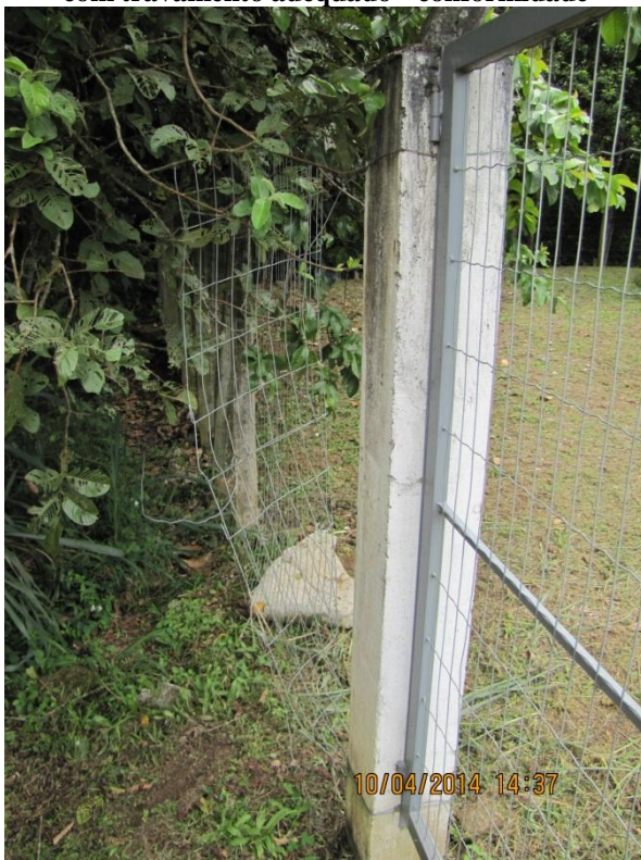
Figura 177 – Reservatório: Cerca de isolamento danificada e com ausência de manutenção – não conformidade
