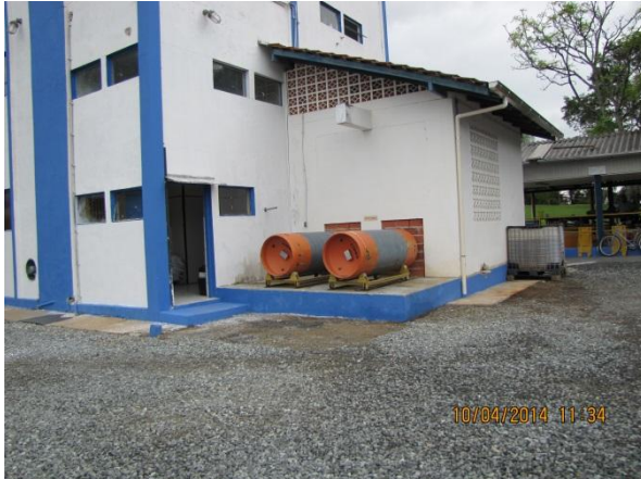
Figura 73 – ETA: Sistema de dosagem de cloro gás desativado. Detalhe da armazenagem dos cilindros do produto químico - conformidade
