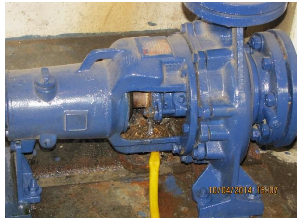
Figura 141 – Estação Elevatória: Detalhe do vazamento na motobomba – não conformidade
