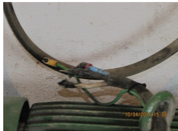
Figura 143 – Estação Elevatória: Detalhe da ausência de aterramento elétrico da motobomba – não conformidade
