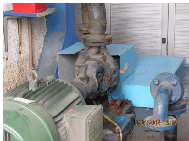
Figura 129 – Estação Elevatória: Detalhe do vazamento na motobomba – não conformidade
