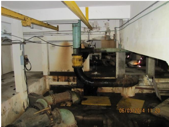
Figura 89 – ETA II: Vista geral da cisterna. Talhas para manutenção em conformidade. Ausência de iluminação adequada – não conformidade
