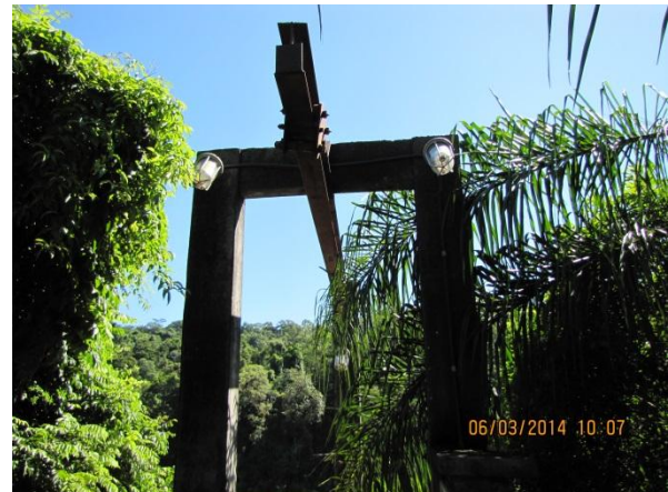
Figura 8 – Captação ETA II: Talha para retirada/instalação da bomba e sistema de iluminação - conformidade
