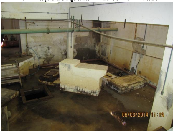
Figura 91 – ETA II: Ausência de conservação, manutenção e limpeza da cisterna. Regiões úmidas danificando pintura e estrutural – não conformidade
