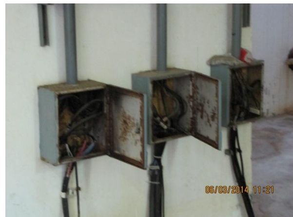
Figura 92 – ETA II: Instalações elétricas aparentes, ausência de proteção e controle da oxidação das partes elétricas - não conformidade
