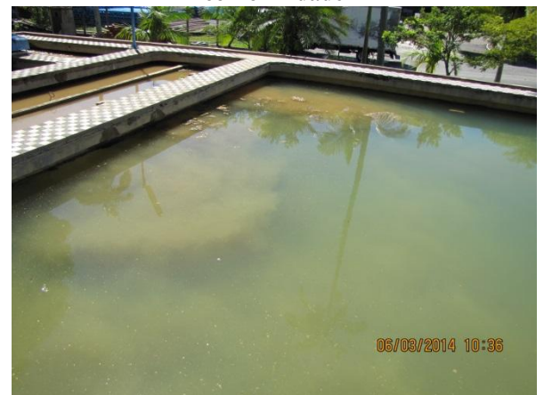
Figura 38 – ETA II: Inexistência de manutenção das barreiras de madeira dos tanques de floculação e decantação causando excesso de passagem de flocos e perda de eficiência – não conformidade
