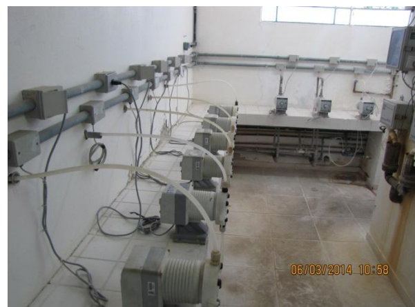
Figura 68 – ETA II: Vista geral da bancada dos dosadores
