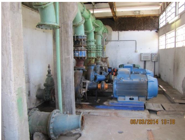
Figura 109 – Estação Elevatória ETA II: Vista Geral. Vazamentos e ausência de proteção mecânica nas motobombas – não conformidade
