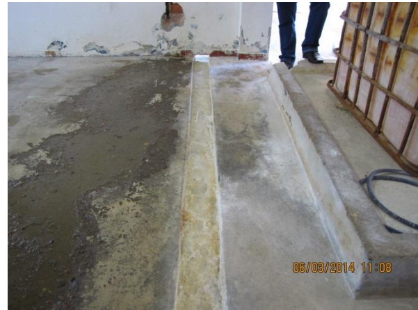
Figura 74 – ETA II: Vazamentos não contidos na calha transportadora e desviados diretamente para drenagem pluvial – não conformidade
