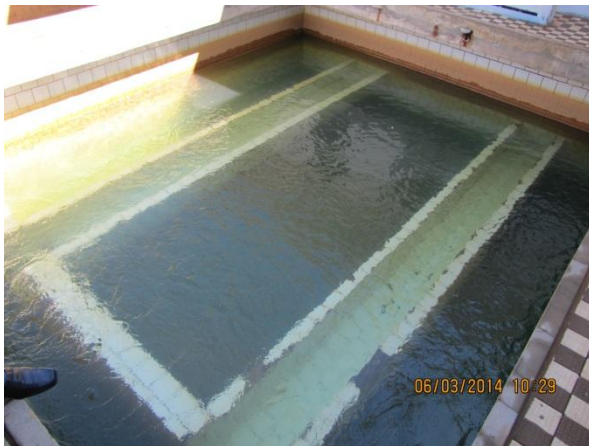
Figura 47 – ETA II: Vista geral do Filtro
