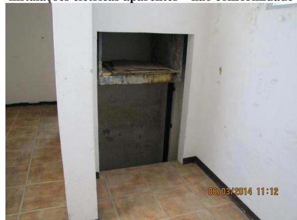
Figura 100 – ETA II: Elevador de cargas desativado. Ausência de guarda-corpo – não conformidade
