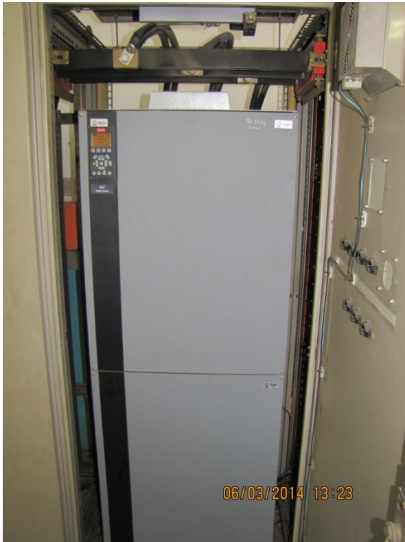
Figura 111 – Estação Elevatória ETA II: Presença de inversor de frequência para acionamento das motobombas - conformidade
