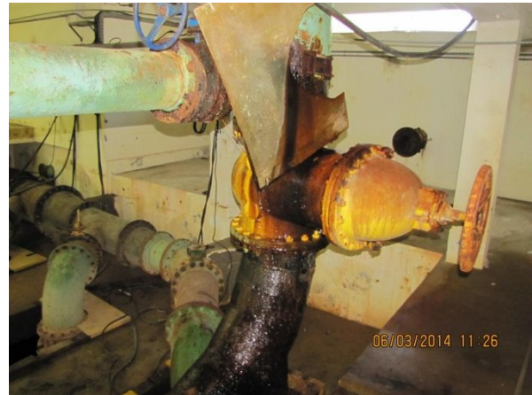
Figura 52 – ETA II: Detalhe das tubulações do filtro com vazamentos e reparo inadequado causando oxidação das válvulas e tubulações – não conformidade
