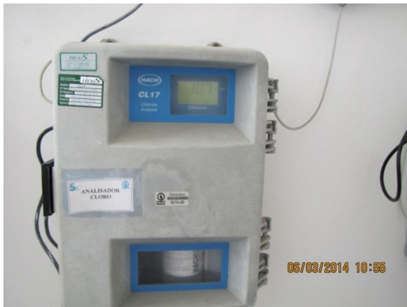
Figura 65 – ETA II: Analisador de cloro com calibração vencida – não conformidade
