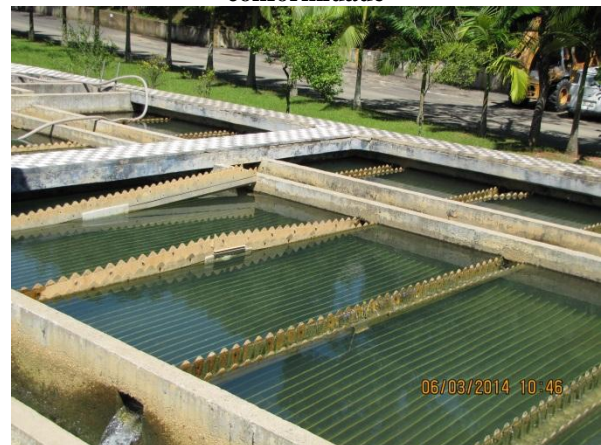
Figura 42 – ETA II: Calhas vertedoras desalinhadas e não operando – não conformidade
