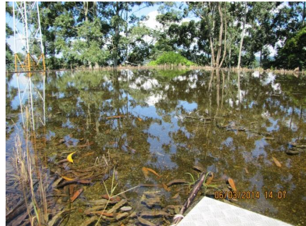
Figura 120 – Reservatório R9: Acúmulo de lâmina de água na parte superior do reservatório. Possível local de proliferação de mosquitos transmissores, indicando ausência de manutenção/limpeza dos drenos – não conformidade
