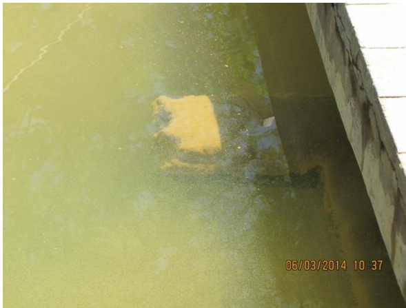
Figura 39 – ETA II: Excesso de material decantado indicando ausência de limpeza do decantador – não conformidade
