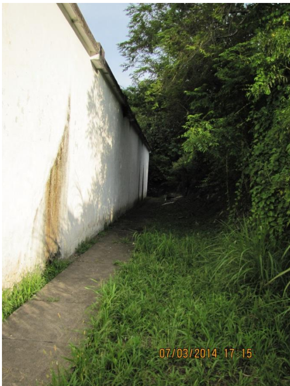
Figura 131 – Reservatório R1: Rachaduras e vazamentos nas paredes do reservatório – não conformidade
