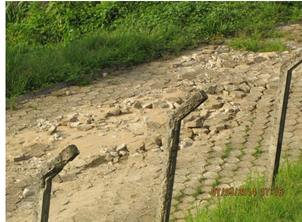
Figura 126 – Reservatório R1: Detalhe do pavimento de acesso de veículos com problemas de conservação – não conformidade
