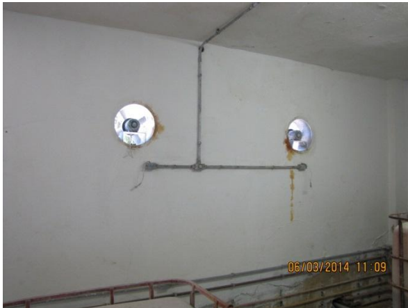
Figura 75 – ETA II: Vista geral do sistema de exaustão.
