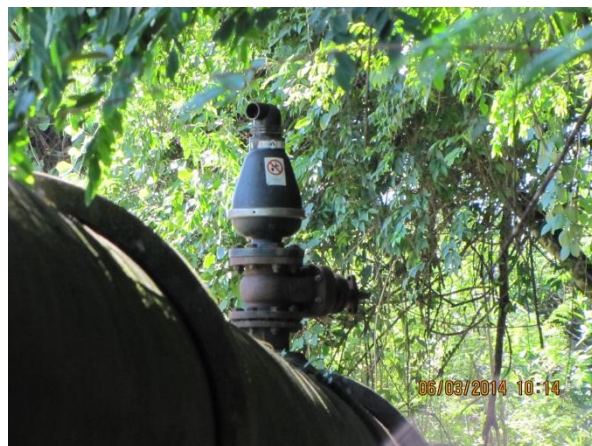
Figura 18 – Adução ETA II: Suspiro instalado ao longo da linha de adução - conformidade
