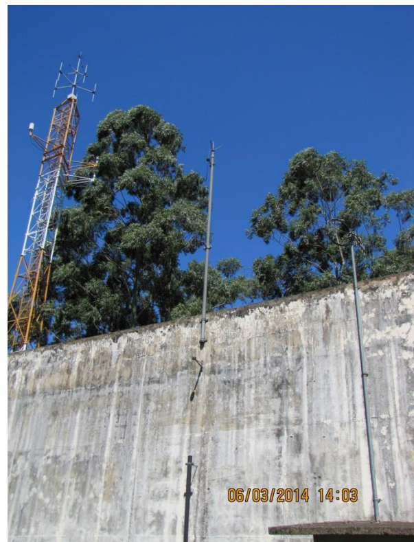
Figura 118 – Reservatório R9: Ausência do cabo do para-raios – não conformidade
