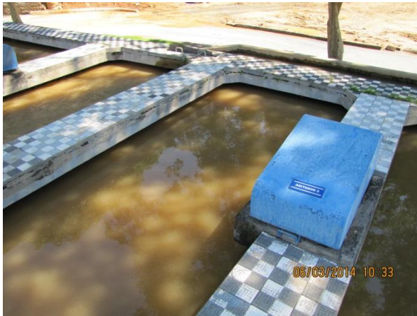
Figura 33 – ETA II: Vista geral do Floculador Mecânico. Do total de 4 (quatro) floculadores apenas 2(dois) estavam operando normalmente – não conformidade
