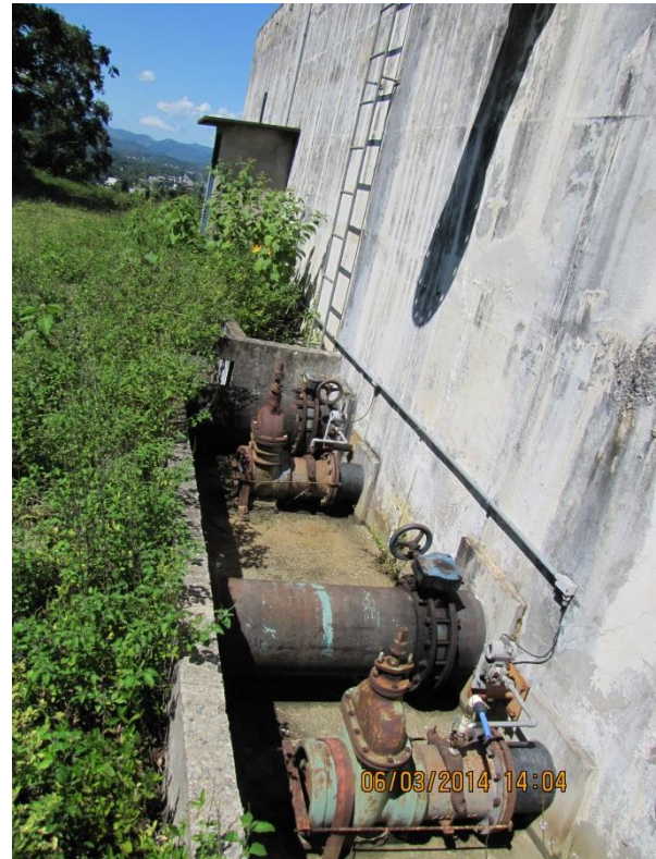
Figura 116 – Reservatório R9: Presença de registros de manobra oxidados e ausência de manutenção – não conformidade
