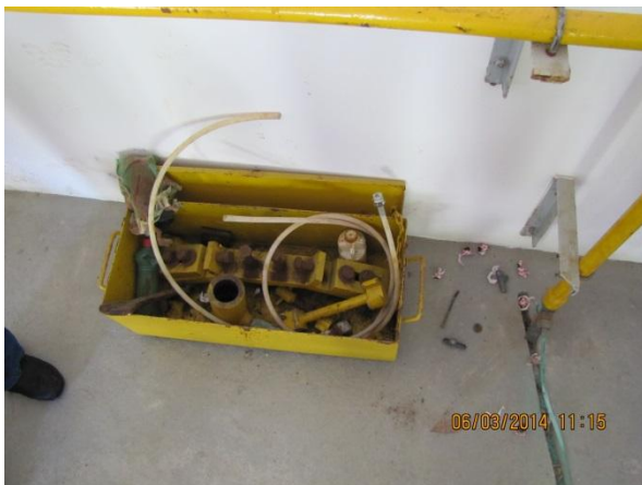
Figura 81 – ETA II: Kit de emergência para reparos do cloro-gás com ausência de itens. Grande parte dos itens apresenta-se oxidada e sem manutenção – não conformidade
