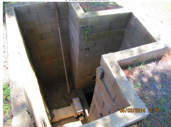
Figura 54 – ETA II: Descarte de lodo dos decantadores e filtros diretamente na rede de drenagem sem tratamento e disposição adequada – não conformidade
