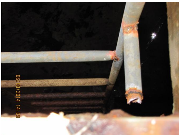
Figura 123 – Reservatório R9: Detalhe da escada de acesso interna oxidada e com falta de fixação adequada – não conformidade
