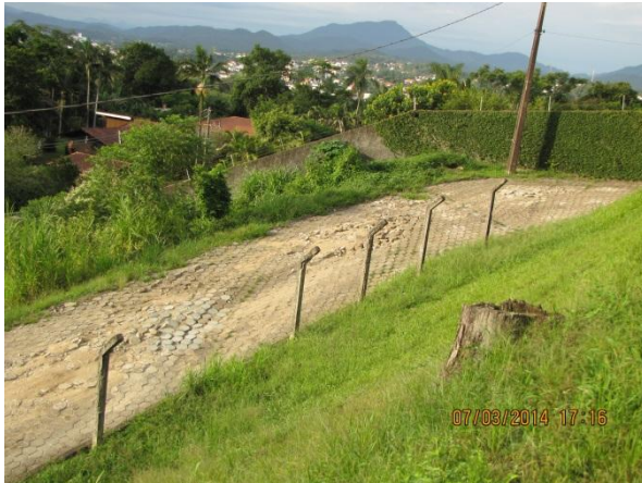
Figura 125 – Reservatório R1: Vista geral. Estrada de acesso para veículos com problemas de conservação do pavimento – não conformidade
