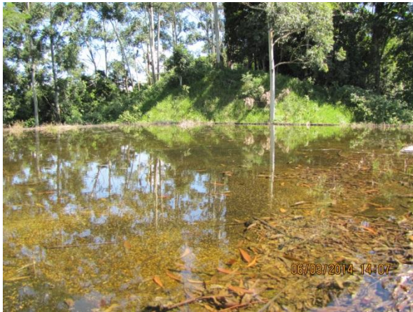
Figura 119 – Reservatório R9: Acúmulo de lâmina de água na parte superior do reservatório. Possível local de proliferação de mosquitos transmissores, indicando ausência de manutenção/limpeza dos drenos – não conformidade
