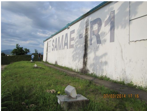
Figura 127 – Reservatório R1: Vista geral. Presença de sistema de iluminação - conformidade. Pintura desgastada – não conformidade
