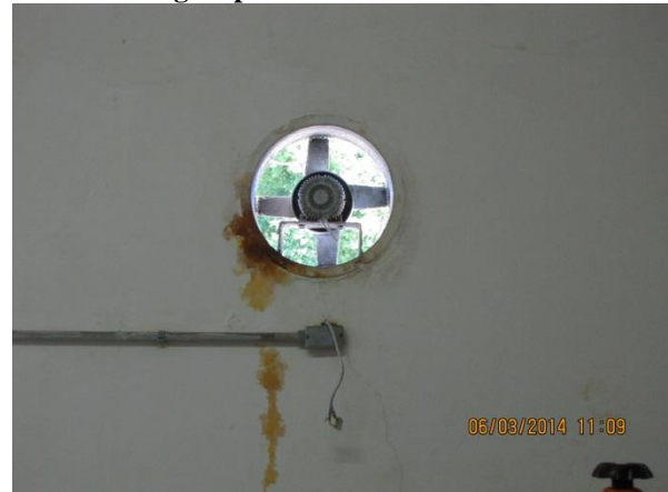
Figura 76 – ETA II: Ambos os exaustores estavam desativados e sem manutenção – não conformidade
