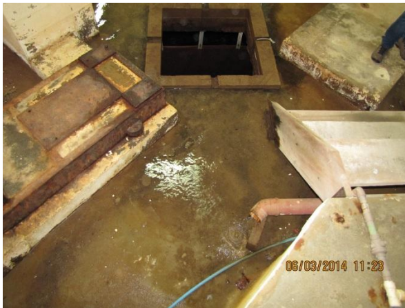
Figura 95 – ETA II: Vazamento contínuo das tubulações ocasionado lavagem da laje e direcionando para a cisterna – não conformidade
