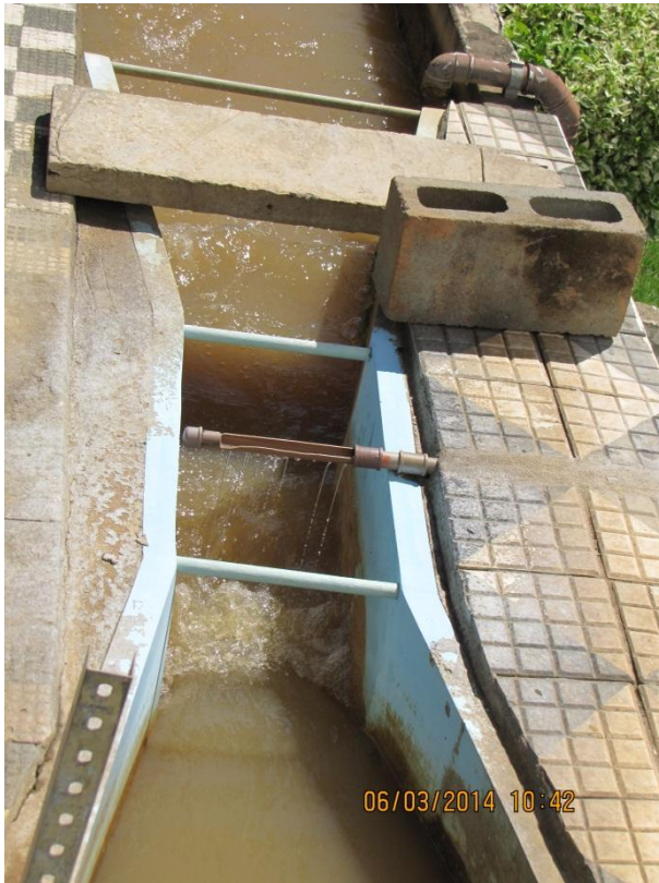
Figura 29 – ETA II: Dosagem de Coagulante - conformidade
