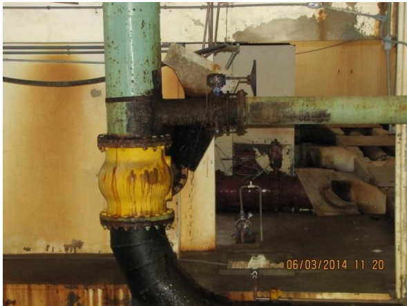
Figura 51 – ETA II: Tubulações do filtro com vazamentos – não conformidade
