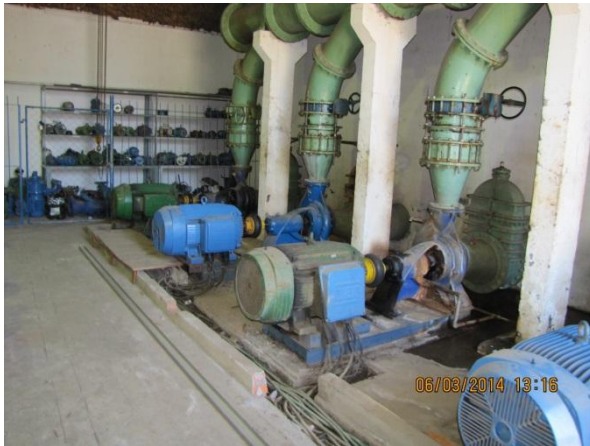
Figura 107 – Estação Elevatória ETA II: Vista geral
