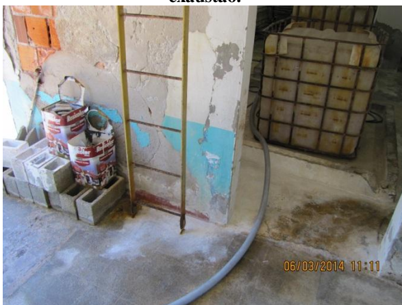
Figura 77 – ETA II: Paredes da casa de química sem reboco adequado. Escada de acesso superior em estado avançado de oxidação. Os vazamentos dos tanques ultrapassam os limites da casa de química – não conformidade
