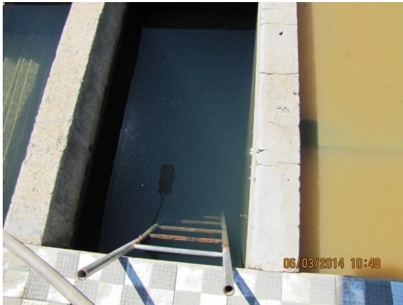
Figura 45 – ETA II: Escada de limpeza dos decantadores em estado avançado de oxidação – não conformidade
