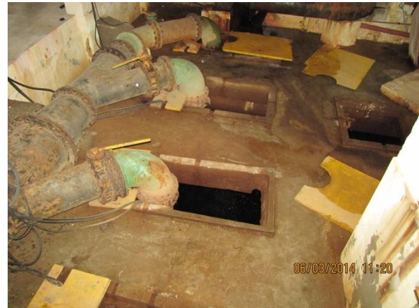
Figura 90 – ETA II: Ausência de tampas, higienização e limpeza da laje da cisterna - não conformidade
