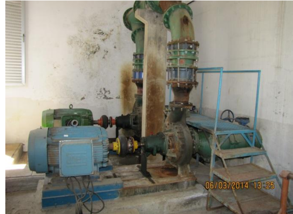
Figura 112 – Estação Elevatória ETA II: Vista Geral. Ausência de proteção mecânica nas motobombas – não conformidade
