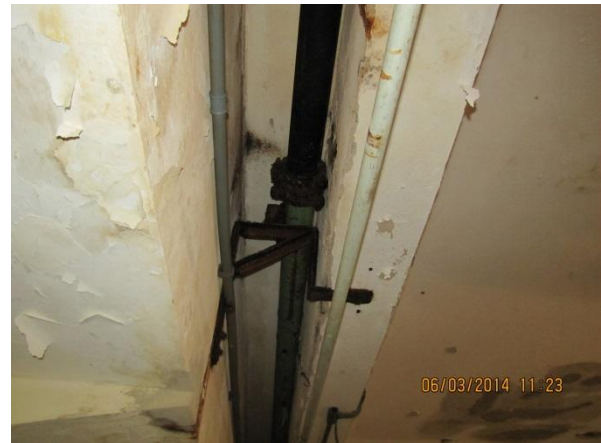
Figura 96 – ETA II: Pintura deteriorada e tubulação em estado avançado de oxidação – não conformidade
