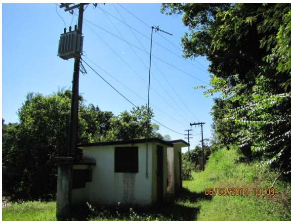
Figura 9 – Captação ETA II: Vista geral das instalações do Quadro de Comando, Quadro de Força e Sistema de Telemetria
