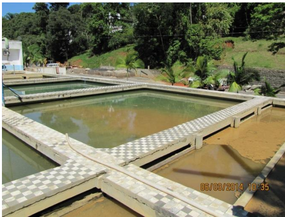
Figura 35 – ETA II: Vista geral dos decantadores. Não existe passarela com guarda-corpo para proteção dos operadores – não conformidade
