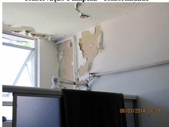
Figura 104 – ETA II: Vestiário com pintura danificada – não conformidade
