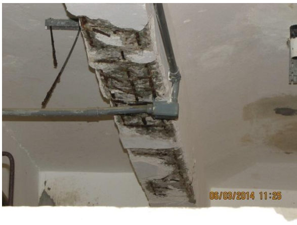
Figura 99 – ETA II: Estrutural comprometido. Ferragens expostas e oxidadas – não conformidade
