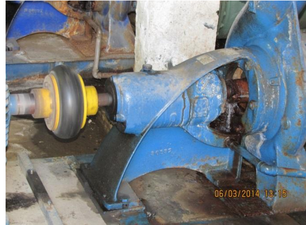
Figura 108 – Estação Elevatória ETA II: Vazamentos e ausência de proteção mecânica nas motobombas – não conformidade
