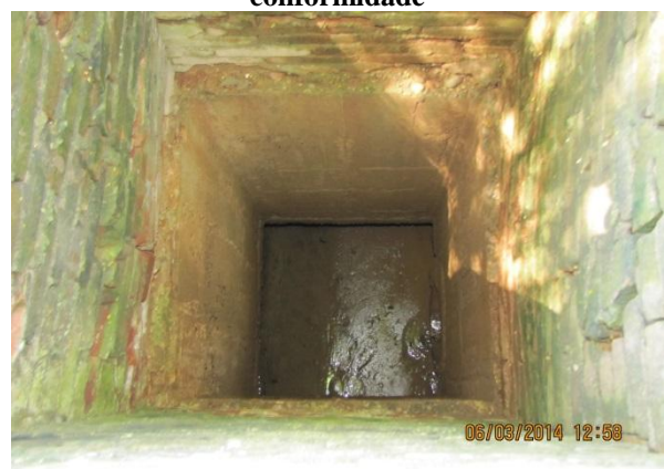
Figura 56 – ETA II: Caixa de passagem do lodo dos filtros e decantadores que após passagem pela drenagem deságua diretamente no Rio Itajaí-Açu sem nenhum tratamento – não conformidade
