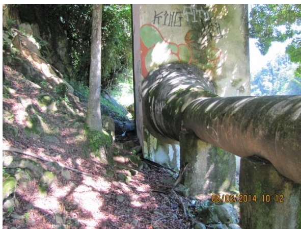
Figura 15 – Adução ETA II: Vista do poço de captação
