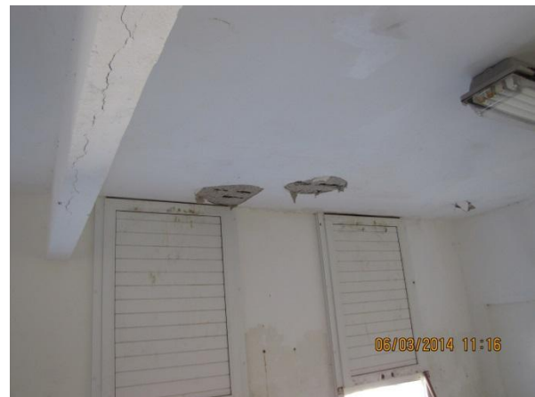
Figura 82 – ETA II: Ferragem da laje exposta e oxidada. Rachaduras de viga visíveis – não conformidade
