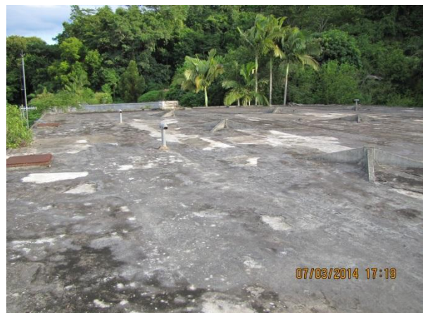
Figura 132 – Reservatório R1: Tubulação de ventilação sem tela de proteção e impermeabilização da laje com desprendimento da fibra de vidro – não conformidade
