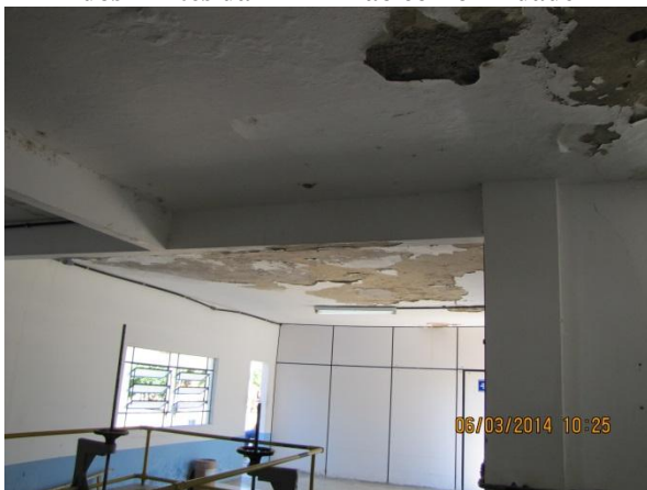
Figura 27 – ETA II: Problemas de conservação e limpeza das instalações. Pintura em estado avançado de deterioração – não conformidade
