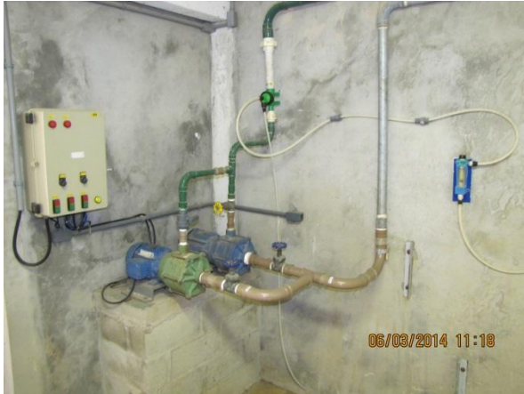
Figura 83 – ETA II: Bombas dosadoras de cloro
