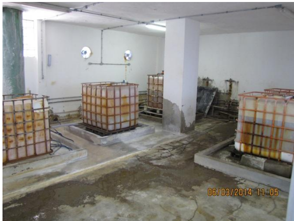
Figura 71 – ETA II: Vista geral da Casa de Química. Ausência de manutenção e limpeza – não conformidade
