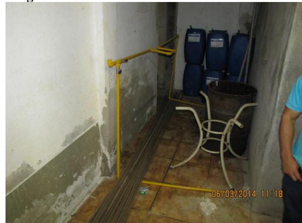
Figura 86 – ETA II: Pintura e conservação não satisfatória. Depósito inadequado de materiais – não conformidade
