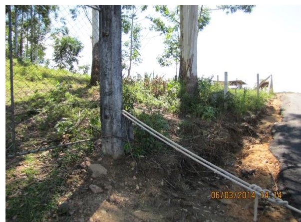
Figura 114 – Reservatório R9: Ausência de cercamento adequado permite o acesso de estranhos e animais do terreno vizinho – não conformidade
