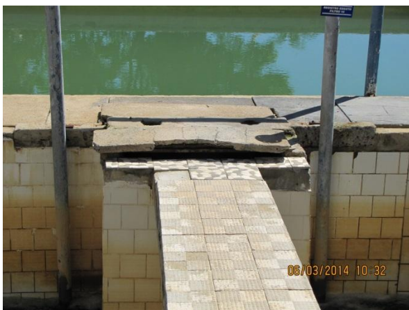
Figura 49 – ETA II: Tampa de concreto danificada – não conformidade
