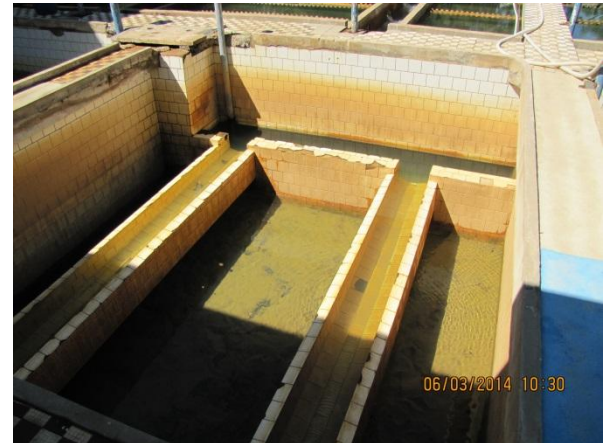
Figura 48 – ETA II: Filtro com azulejos danificados e ausência de limpeza – não conformidade
