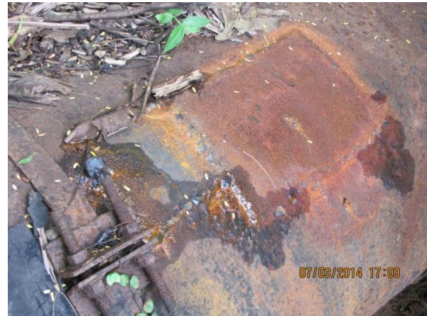
Figura 22 – Adução ETA II: Detalhe da adutora em avançado estado de deterioração e oxidação. Presença de vazamentos, fissuras e inúmeros reparos paliativos – não conformidade
