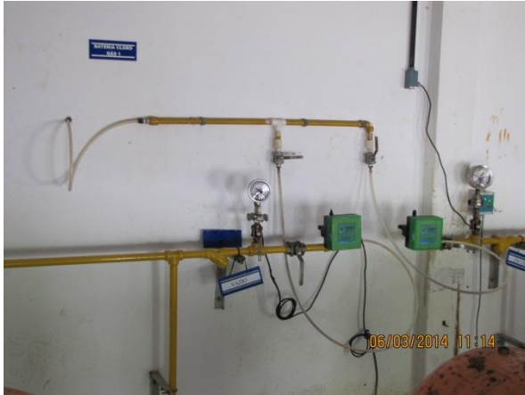
Figura 79 – ETA II: Dosadores e controle do cloro gás em bom estado de conservação - conformidade
