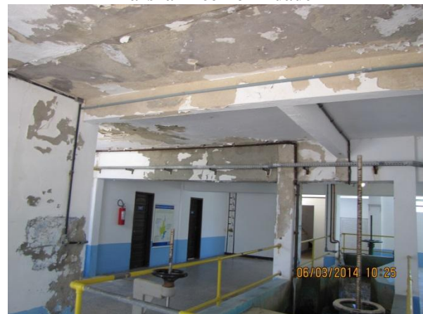
Figura 28 – ETA II: Problemas de conservação e limpeza das instalações. Pintura em estado avançado de deterioração – não conformidade
