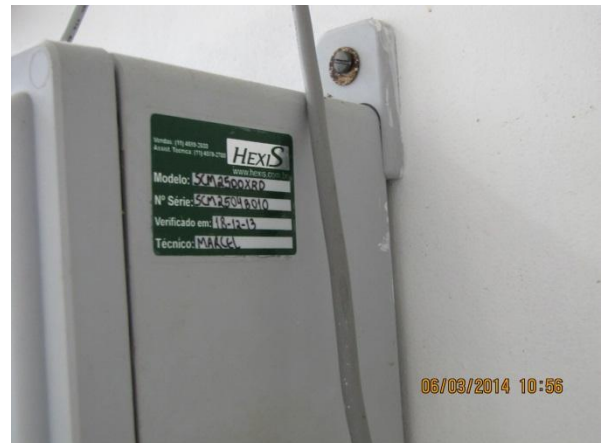
Figura 66 – ETA II: Detalhe da etiqueta de controle de calibração
