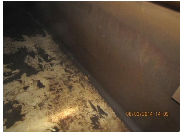
Figura 124 – Reservatório R9: Detalhe ausência de higienização e limpeza – não conformidade
