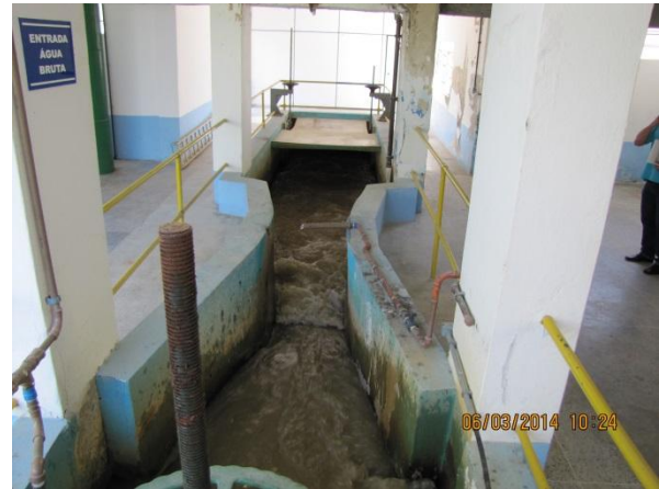
Figura 26 – ETA II: Entrada de água bruta. Calha Parshall - conformidade
