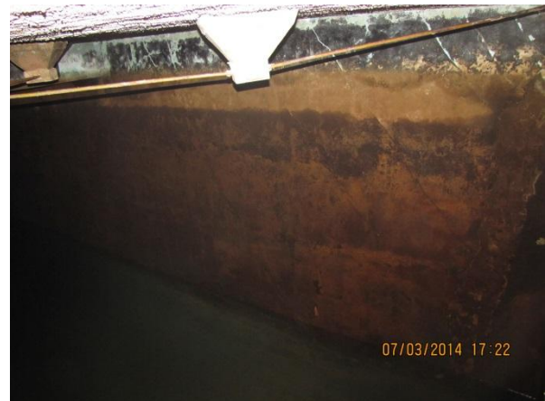
Figura 136 – Reservatório R1: Detalhe ausência de higienização e limpeza – não conformidade
