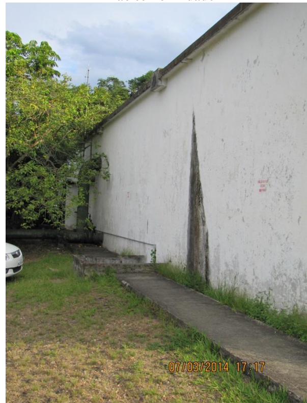
Figura 128 – Reservatório R1: Rachaduras e vazamentos nas paredes do reservatório – não conformidade
