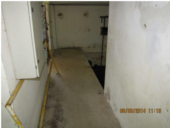
Figura 87 – ETA II: Ausência de guarda-corpo no acesso a cisterna – não conformidade
