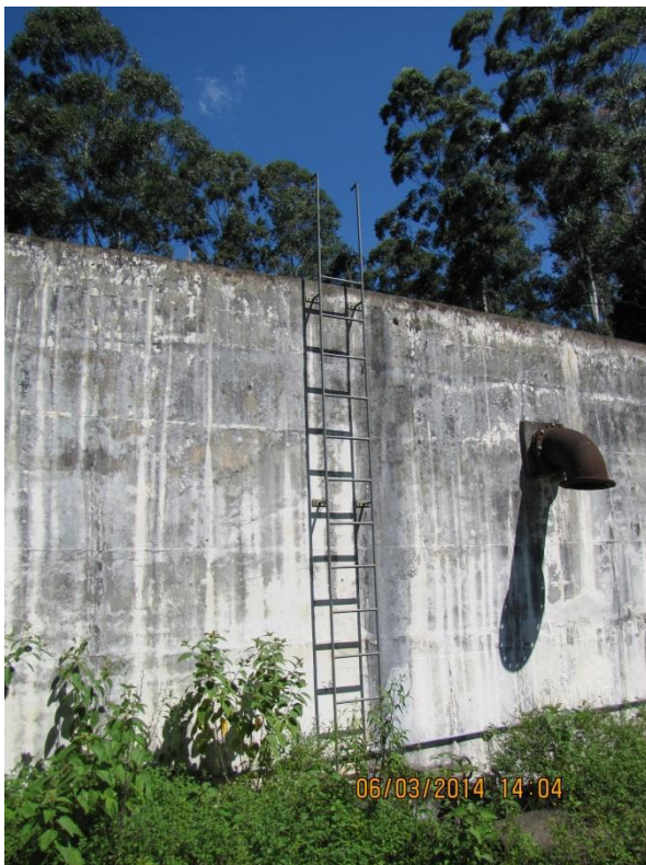
Figura 117 – Reservatório R9: Tubo extravasor. Escada de acesso ao reservatório sem gaiola de proteção – não conformidade
