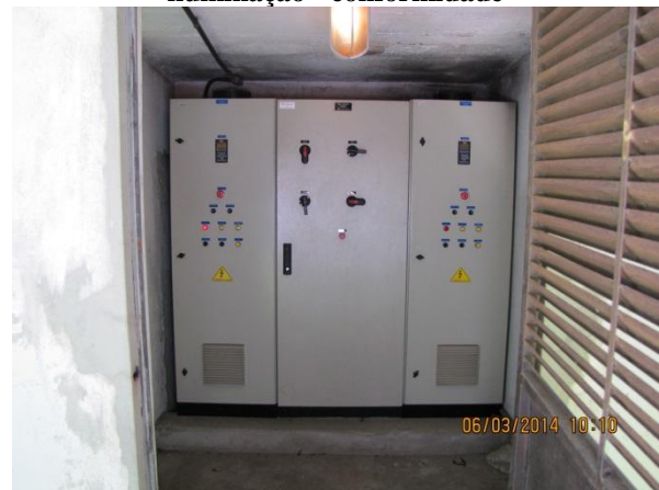
Figura 10 – Captação ETA II: Quadro de comando e Quadro de força - conformidade.
