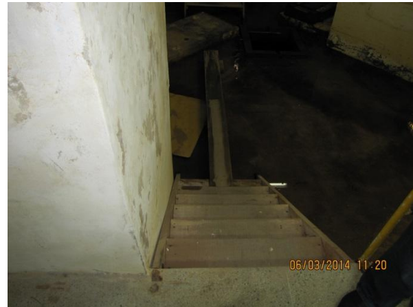
Figura 88 – ETA II: Ausência de acesso adequado a cisterna. Escadas e passarelas em madeira - não conformidade.
