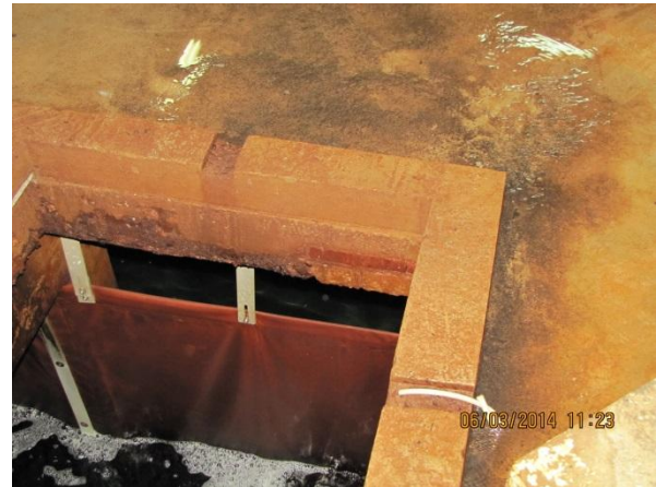
Figura 94 – ETA II: Ausência de tampa e isolamento da cisterna. Presença de drenos que permitem o escoamento de água suja para dentro da cisterna - não conformidade
