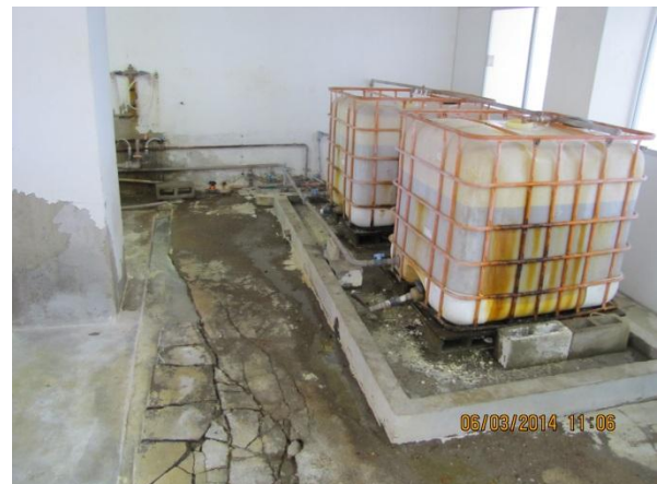
Figura 72 – ETA II: Estrutura dos tanques com grandes partes oxidadas. Contra piso rachado e danificado podendo afetar a estrutura da laje. Tanque de contenção não satisfatório – não conformidade
