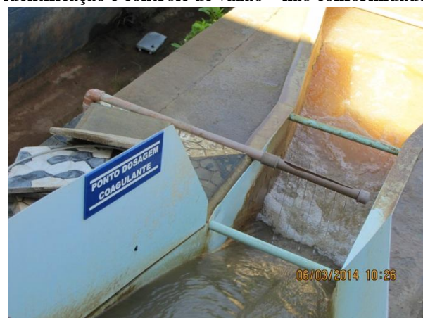
Figura 32 – ETA II: Dosagem de Coagulante - conformidade
