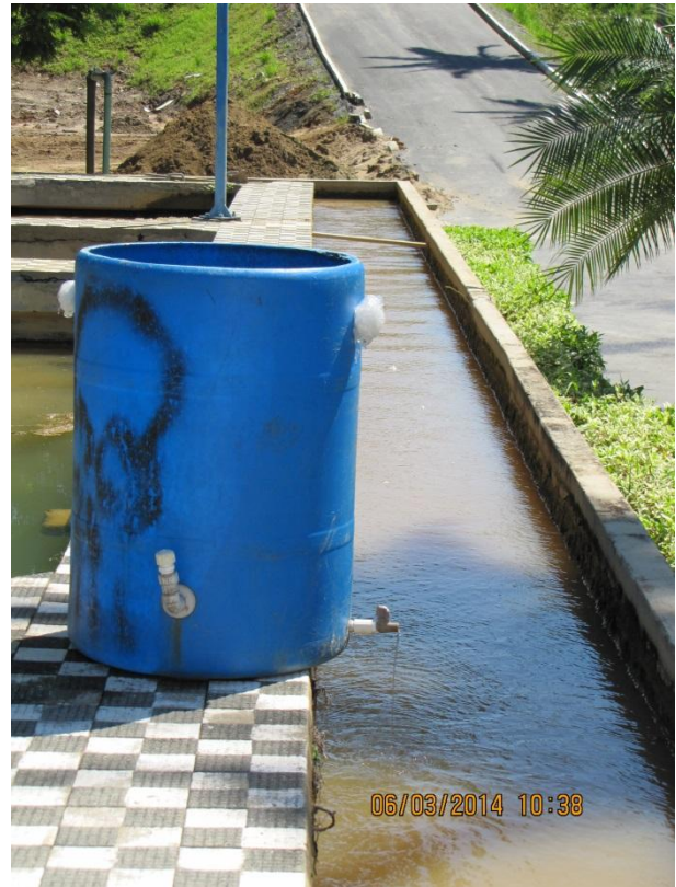
Figura 30 – ETA II: Dosagem de reagente sem identificação e controle de vazão – não conformidade
