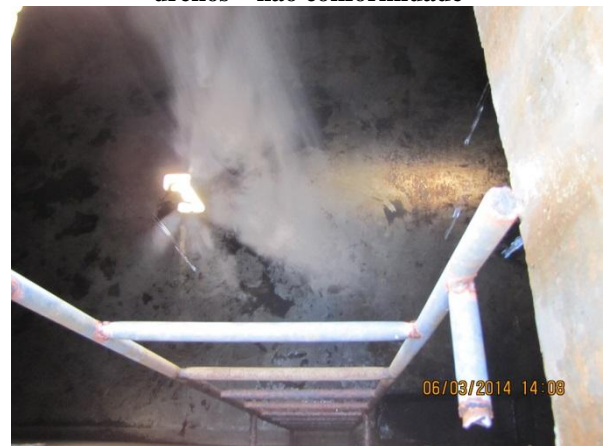
Figura 122 – Reservatório R9: Acúmulo de lodo no fundo do reservatório, escada de acesso interna oxidada e com falta de fixação adequada – não conformidade
