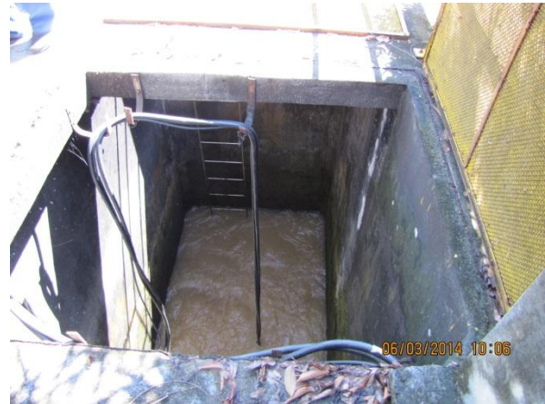
Figura 6 – Captação ETA II: Vista interna do poço de bombeamento. Ausência de bomba reserva em paralelo com acionamento automático – não conformidade
