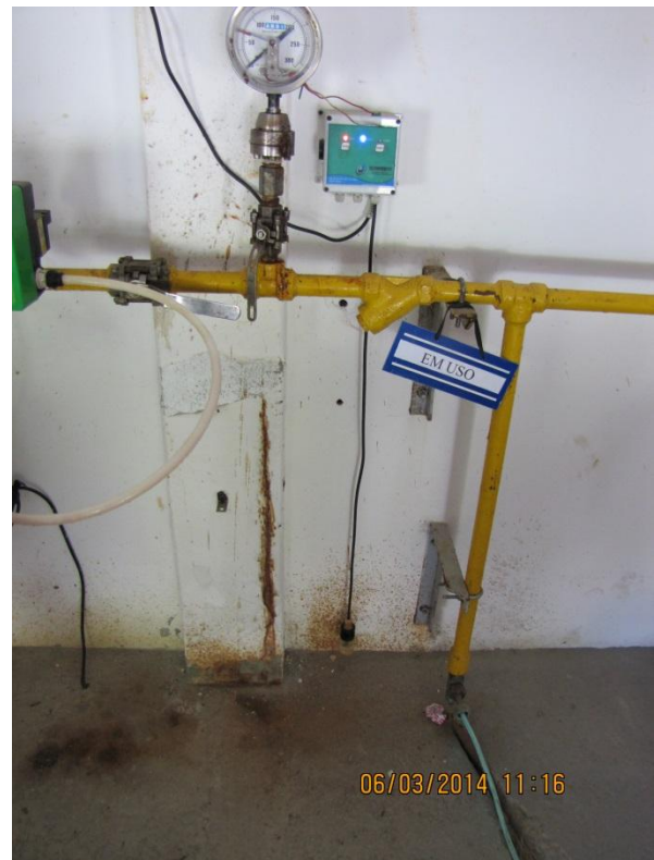
Figura 80 – ETA II: Detalhe dos dosadores e controles
