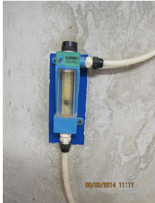
Figura 84 – ETA II: Detalhe do dosador de cloro
