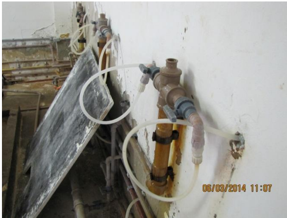
Figura 73 – ETA II: Vazamento nas tubulações dosadoras. Ausência de manutenção e limpeza – não conformidade
