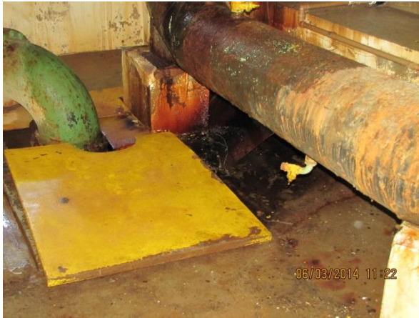
Figura 93 – ETA II: Tubulações oxidadas com vazamentos. Entrada de água dos vazamentos na cisterna – não conformidade
