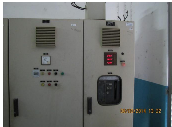
Figura 110 – Estação Elevatória ETA II: Quadros de comando - conformidade
