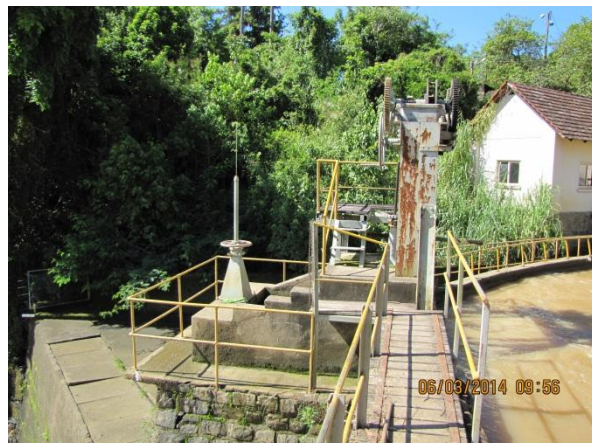
Figura 2 – Captação ETA II: Ponto de captação
