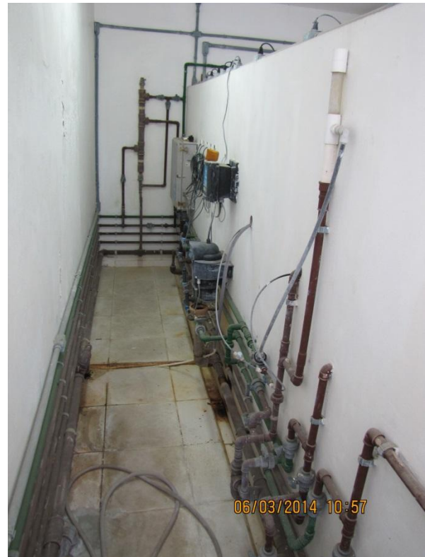
Figura 70 – ETA II: Ausência de limpeza e manutenção do piso – não conformidade
