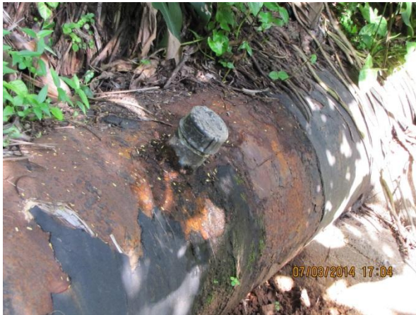
Figura 21 – Adução ETA II: Adutora em avançado estado de deterioração e oxidação. Presença de vazamentos, fissuras e inúmeros reparos paliativos – não conformidade
