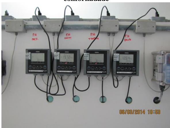
Figura 61 – ETA II: Dos 4(quatro) pHmetro, 3(três) apresentavam erro e descalibração – não conformidade
