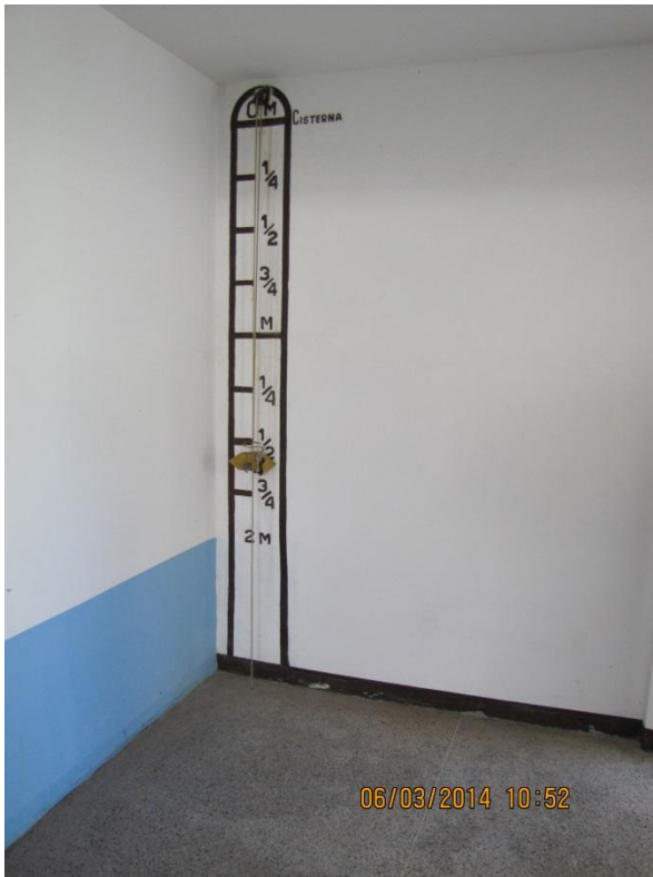
Figura 97 – ETA II: Controle de nível da cisterna
