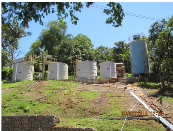
Figura 57 – ETA II: Vista geral dos tanques de PAC
