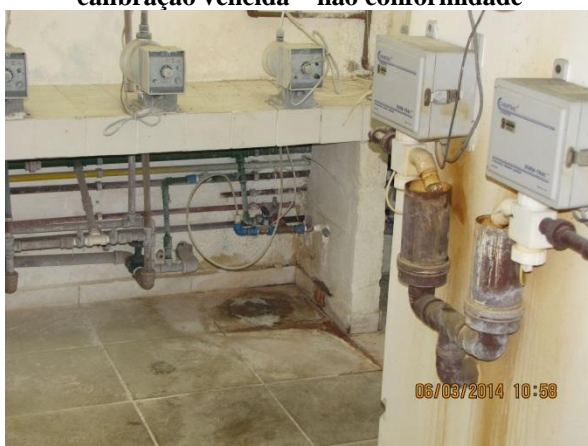
Figura 67 – ETA II: Ausência de limpeza e manutenção dos pisos e bancadas da sala dos dosadores – não conformidade
