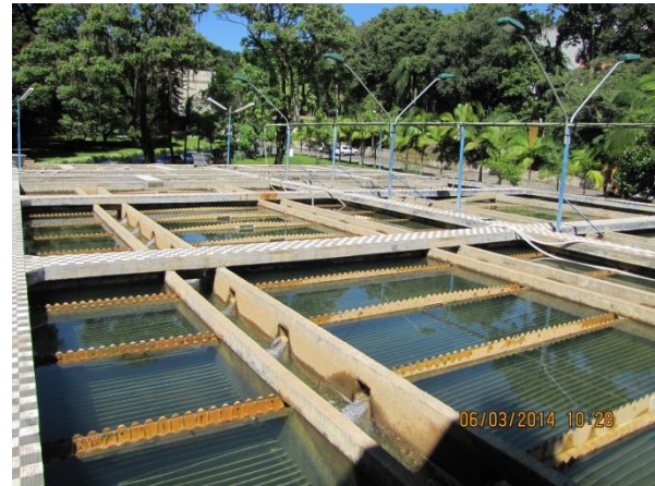
Figura 40 – ETA II: Vista geral dos decantadores de placas laminares. Não existe passarela com guarda-corpo de proteção dos operadores – não conformidade
