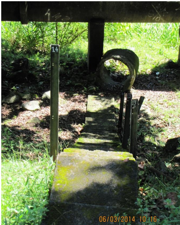
Figura 13 – Adução ETA II: Escada de acesso com ausência de corrimão – não conformidade
