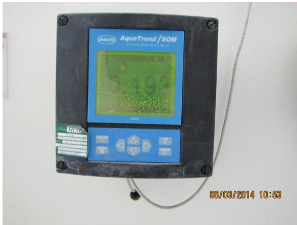
Figura 63 – ETA II: Turbidímetro de água tratada - conformidade
