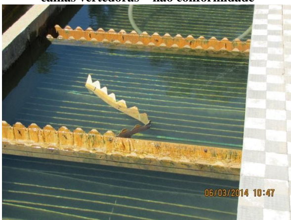
Figura 43 – ETA II: Calhas vertedoras danificadas – não conformidade
