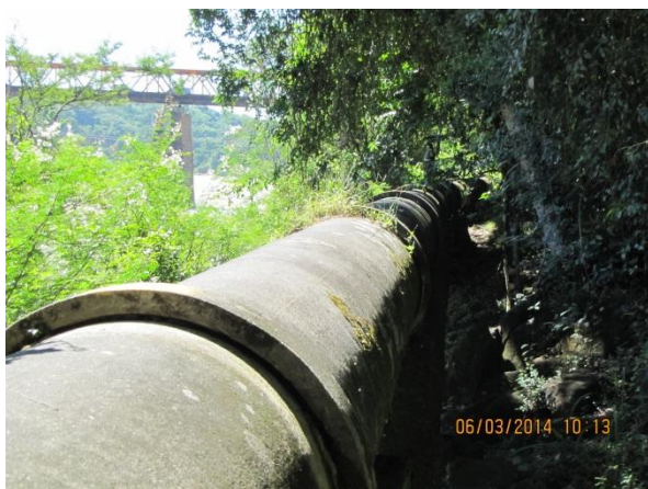
Figura 17 – Adução ETA II: Detalhe da dificuldade de acesso para manutenção ao longo da linha de adução – não conformidade
