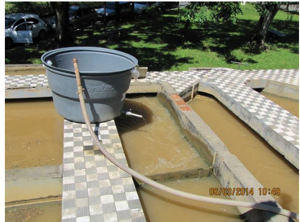
Figura 34 – ETA II: Floculador hidráulico com dosagem de reagente sem identificação e controle de vazão. Ausência de tampa de vedação – não conformidade
