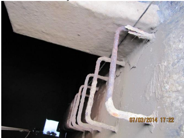
Figura 135 – Reservatório R1: Detalhe da escada de acesso interno em estado avançado de oxidação – não conformidade
