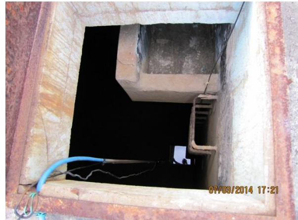
Figura 134 – Reservatório R1: Escada de acesso interno em estado avançado de oxidação e fiação elétrica desprotegidas – não conformidade
