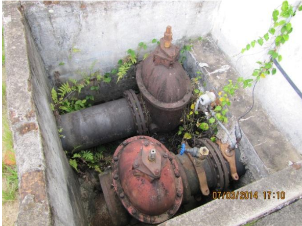
Figura 129 – Reservatório R1: Registros de manobra oxidados – não conformidade
