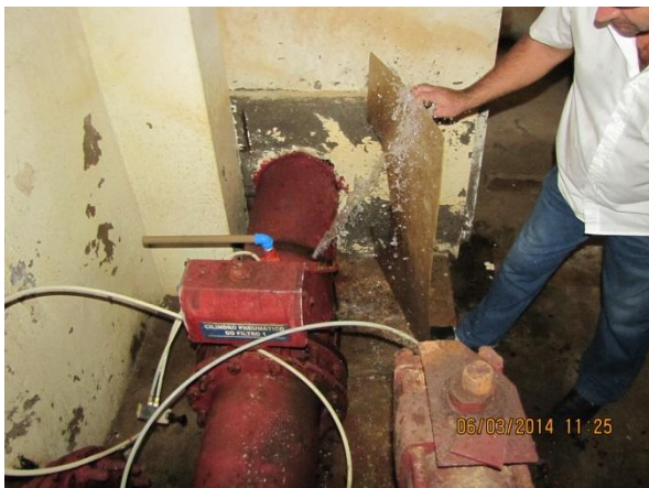
Figura 53 – ETA II: Vazamento contido de forma não técnica – não conformidade
