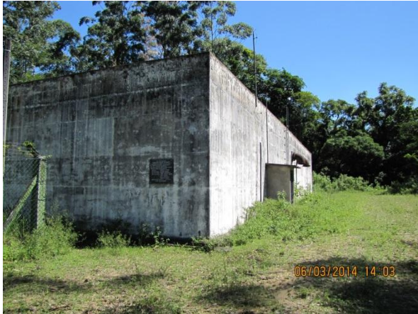
Figura 115 – Reservatório R9: Vista geral. Pintura desgastada. Limpeza e roçado em não conformidade. Ausência de sistema de iluminação para trabalhos de manutenção noturno – não conformidade
