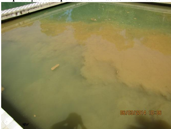
Figura 37 – ETA II: Detalhe do arraste dos flocos de forma desordenada prejudicando a eficiência do decantador e acarretando rápida colmatação dos filtros – não conformidade
