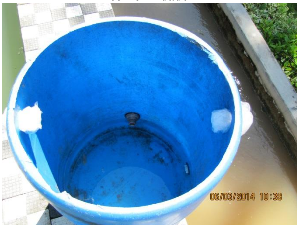
Figura 31 – ETA II: Reservatório do reagente sem controle de nível e vazão - não conformidade
