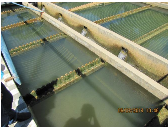
Figura 41 – ETA II: Ausência de limpeza das calhas vertedoras – não conformidade
