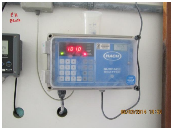
Figura 62 – ETA II: Turbidímetro de água bruta - conformidade
