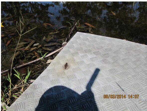
Figura 121 – Reservatório R9: Ausência de cadeado na tampa de inspeção e passagem de águas pluviais para o interior do reservatório – não conformidade
