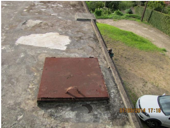
Figura 133 – Reservatório R1: Tapa de inspeção sem cadeado, oxidada e com problemas nas dobradiças – não conformidade
