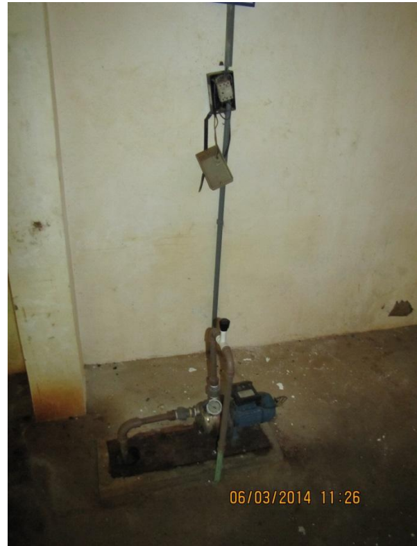
Figura 98 – ETA II: Equipamento desativado e instalações elétricas aparentes – não conformidade
