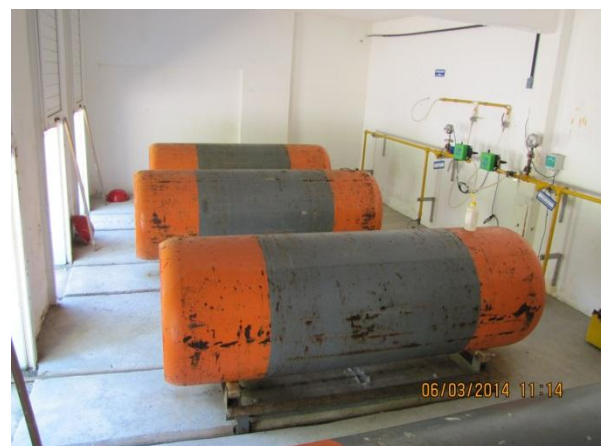
Figura 78 – ETA II: Vista geral das instalações do cloro gás
