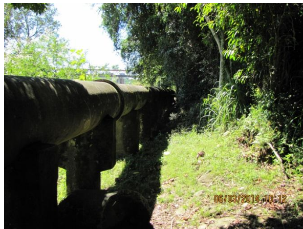
Figura 16 – Adução ETA II: Dificuldade de acesso para manutenção ao longo da linha de adução – não conformidade
