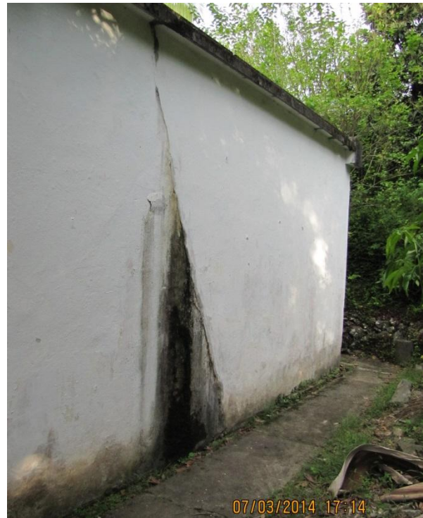
Figura 130 – Reservatório R1: Rachaduras e vazamentos nas paredes do reservatório – não conformidade
