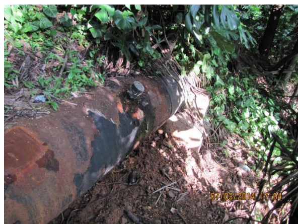
Figura 20 – Adução ETA II: Adutora de água tratada localizada próxima a Rua Bahia com passagem em propriedade particular – não conformidade
