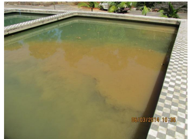
Figura 36 – ETA II: Decantador operando com excesso de material oriundo dos floculadores – não conformidade
