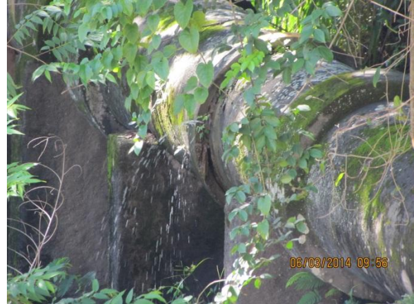
Figura 12 – Adução ETA II: Vazamento na adutora – não conformidade. Em janeiro de 2013 já foi comunicado a direção de operações esta não conformidade.
