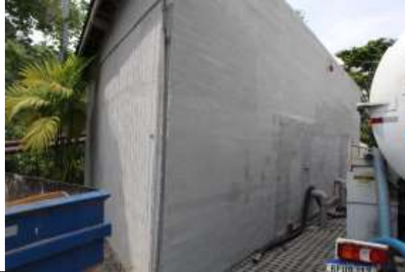
SISTEMA DE BIOFILTRAÇÃO COM ACESSÓRIOS
