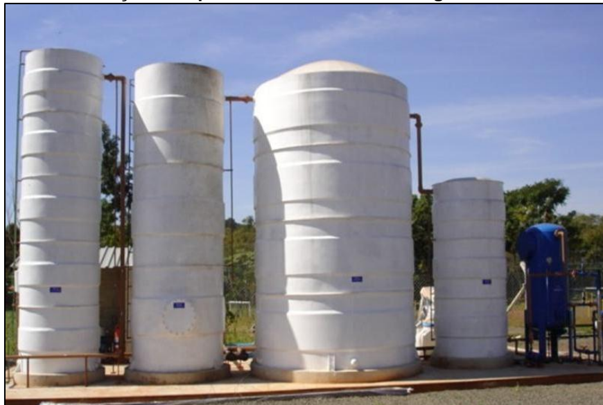
Figura 2.11 - Estação Compacta de Tratamento de Esgotos Sanitários.
